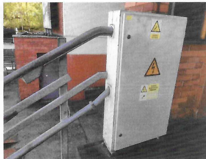
12 rozvaděč pro plošinu.jpg
