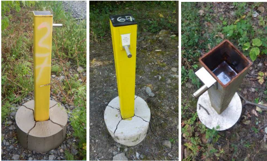
Obrázek 19 Popraskané betonové základy zajišťovacích značek ŽPSV
