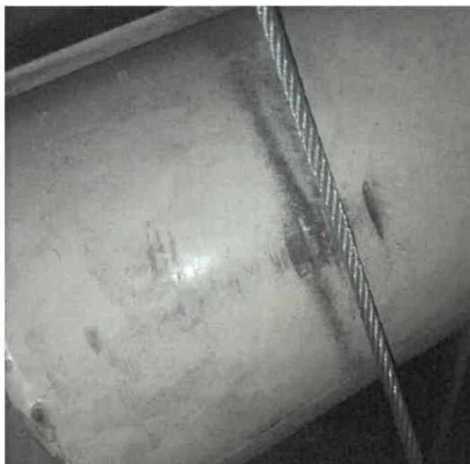
OBR: 25 – Zářezy v hlavní nosné ocelové konstrukci od lanek AV techniky
