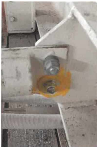
OBR: 16 – Doplněný šroub, otvor překrytý velkoplošnou podložkou
