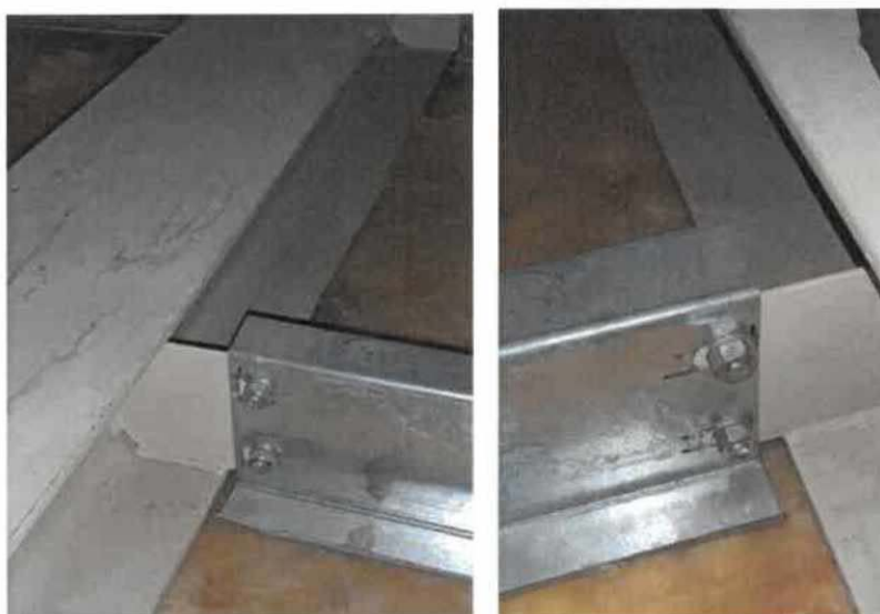
OBR: 14, 15 – Poškozené přípoje Z-paždíků
