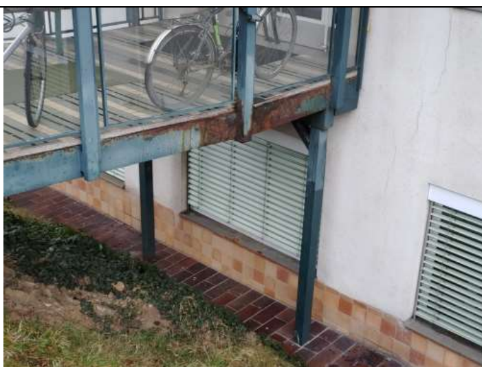
DETAIL POŠKOZENÍ NOSNÝCH PRVKŮ
