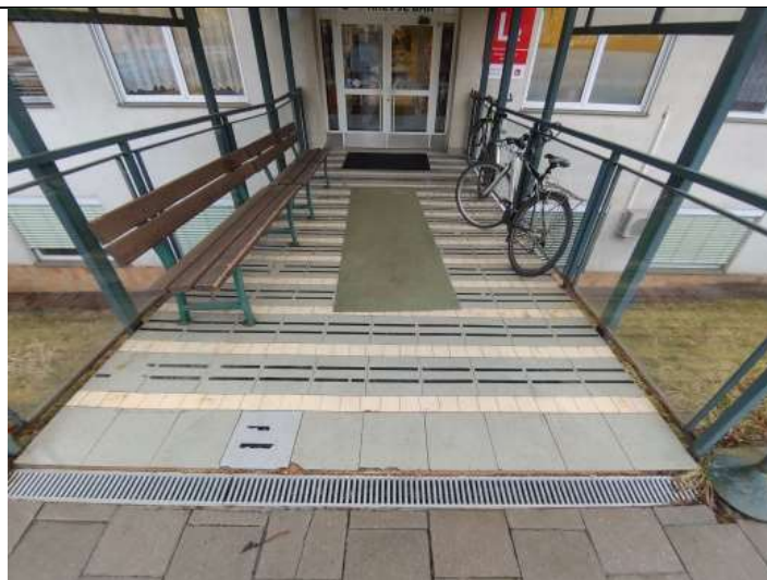
DETAIL STÁVAJÍCÍ NEVYHOVUJÍCÍ DLAŽBY
