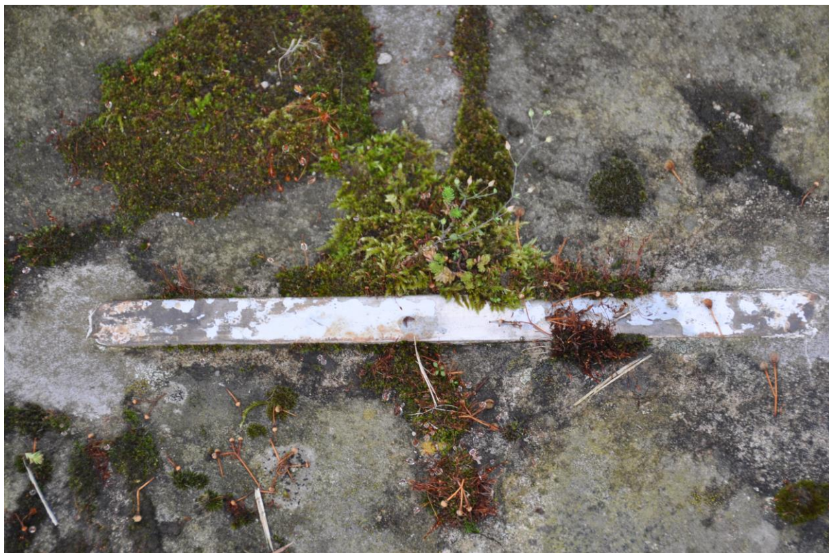
Obrázek 12 - Korodující kramle s poškozeným nátěrovým systémem
