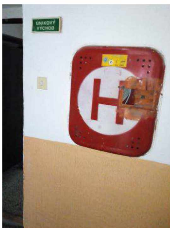
Nedostatek 2: Opatřebovaná hydrantová skříň.
