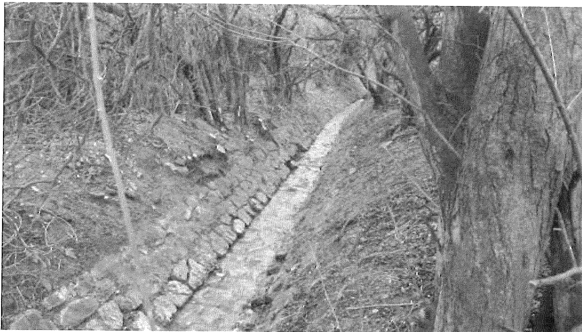
Obr. č. 1: Úsek ř. km 1, 868 – 1,986 VT PP Dyje – viditelné pomístné narušení dlažeb
