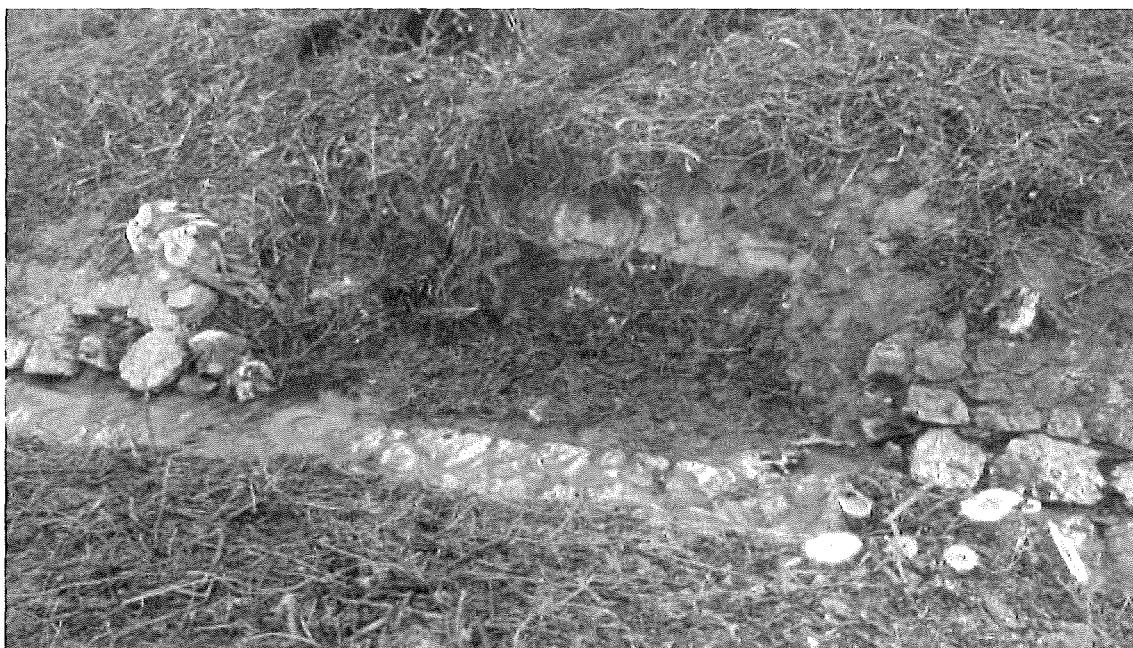
Obr. č. 3: Pohled na kavernu na pravém břehu VT, úsek ř. km 1, 868 – 1,986 VT PP Dyje
