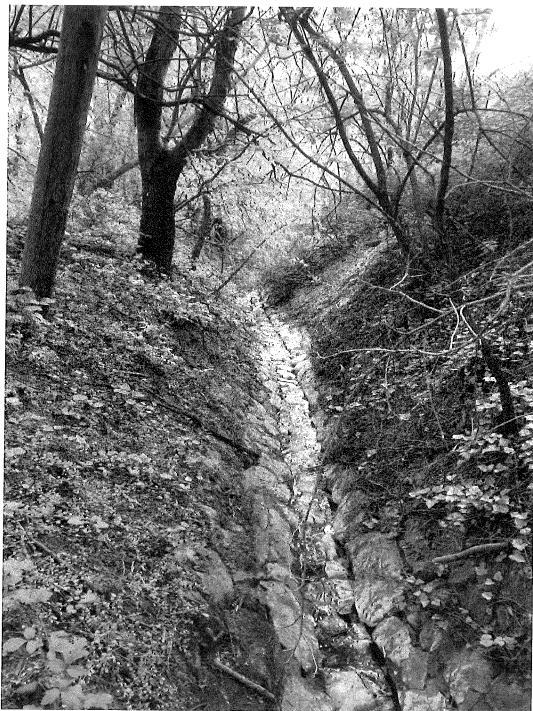
Obr. č. 12: Podélné opevnění koryta levostranného přítoku – kam. dlažba stabilní, degradované spárování.
