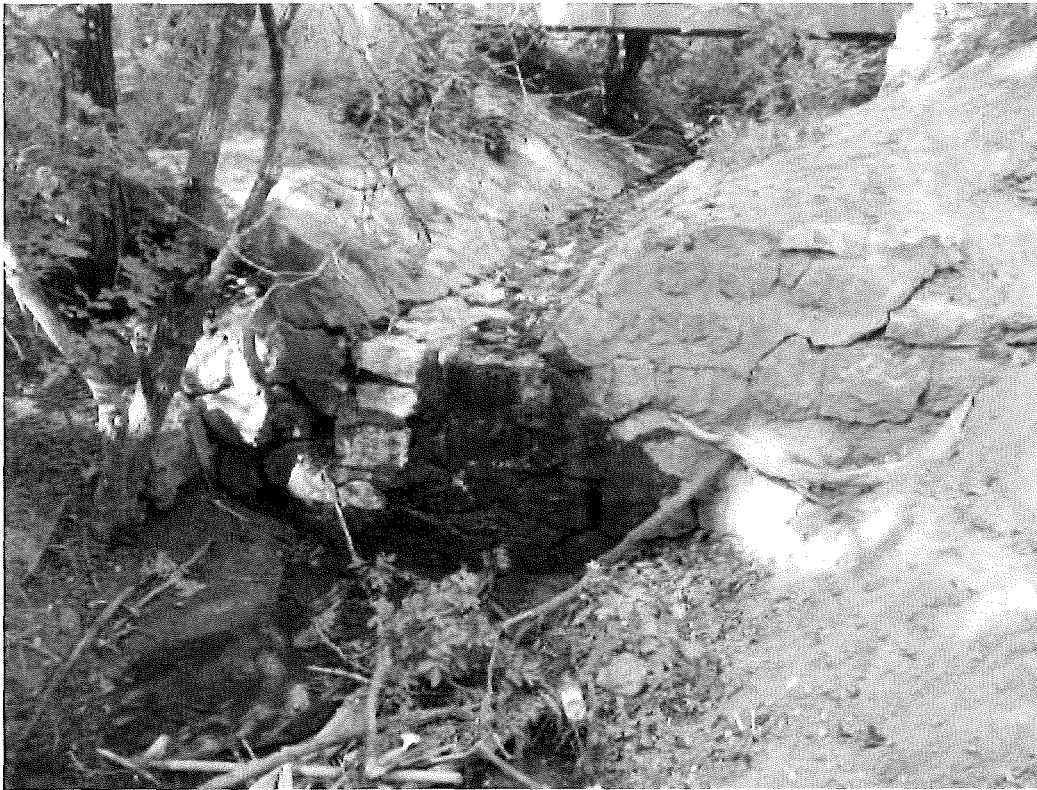
Obr. č. 10: Kam. stupeň na levostranném přítoku (GPS: 48.8757706N, 16.6721900E) určený k celkové rekonstrukci
