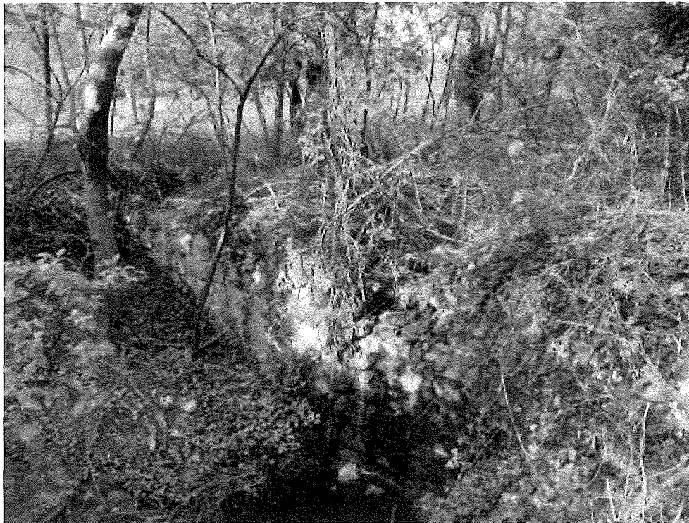
Obr. č. 11: Kam. stupeň na levostranném přítoku (GPS: 48.8758758N, 16.6729464E) určený k opravě – rozplavující se „přelivná hrana“
