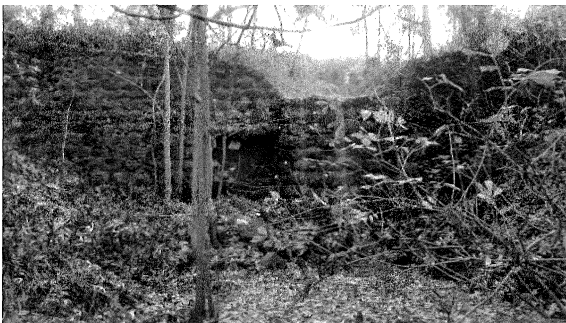
Obr. č. 4: Poškozený kamenný stupeň v ř. km 2,080 VT PP Dyje, určený ke kompletní rekonstrukci
