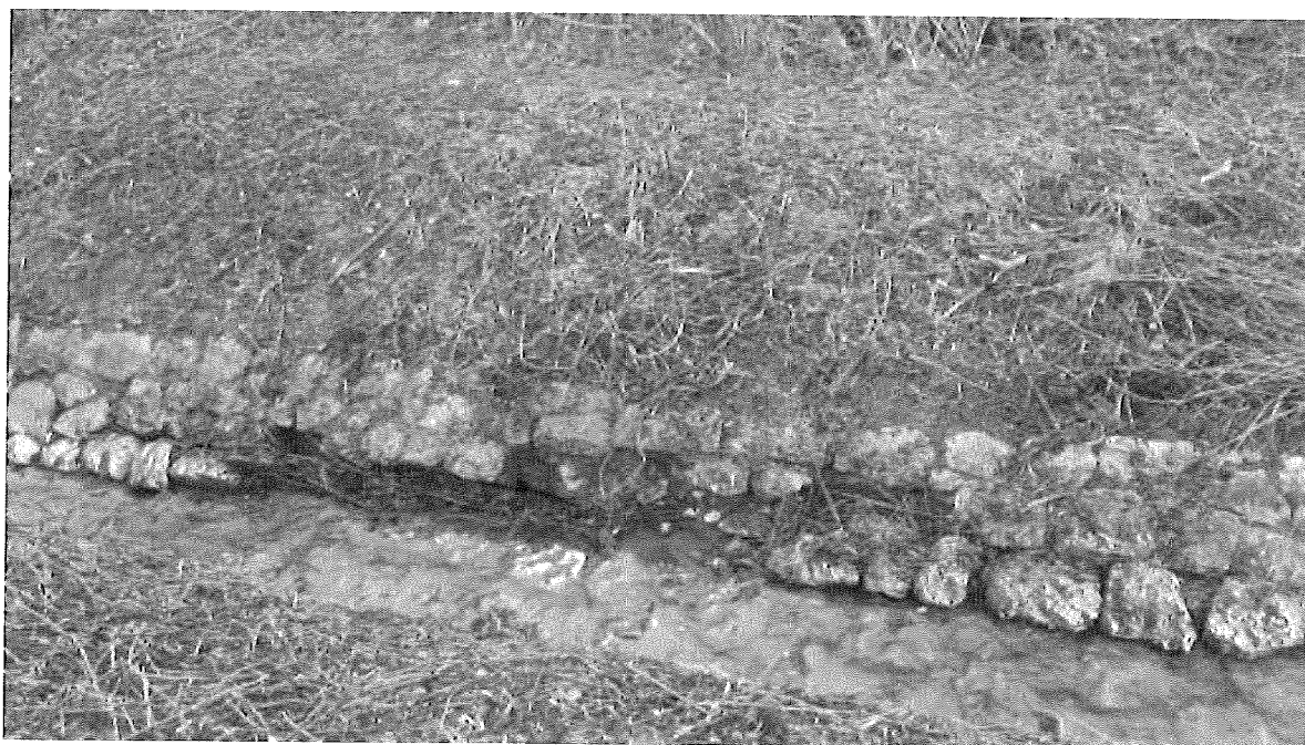
Obr. č. 2: Pohled na narušené podélné opevnění VT, úsek v ř. km 1, 868 – 1,986 VT PP Dyje
