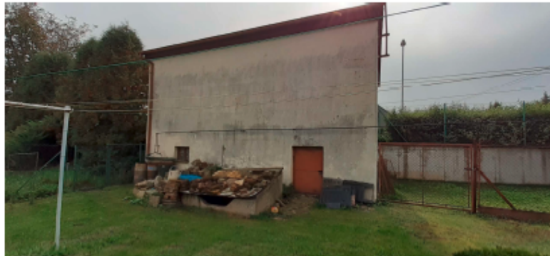
Obr. 10 – Stávající nevzhledné omítky
