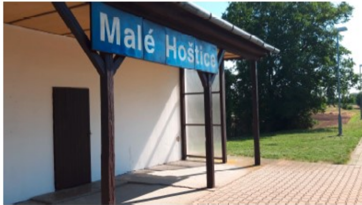
Obr. 7 – Stávající nápisy jsou nevyhovující, bet. podlaha je popraskaná
