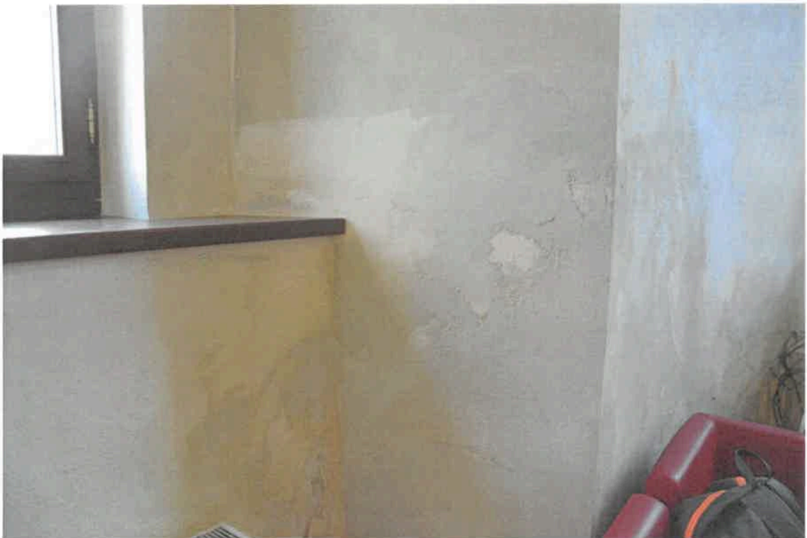
8. Poškozená barva vlhkostí na stěnách. Barva zpráškovatěla.
