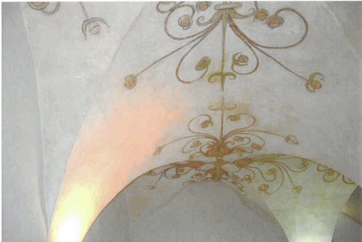
12. Prachovými deponenty pokrytá plocha s malbou a lokální změny barevnosti díky vzdušné vlhkosti.
