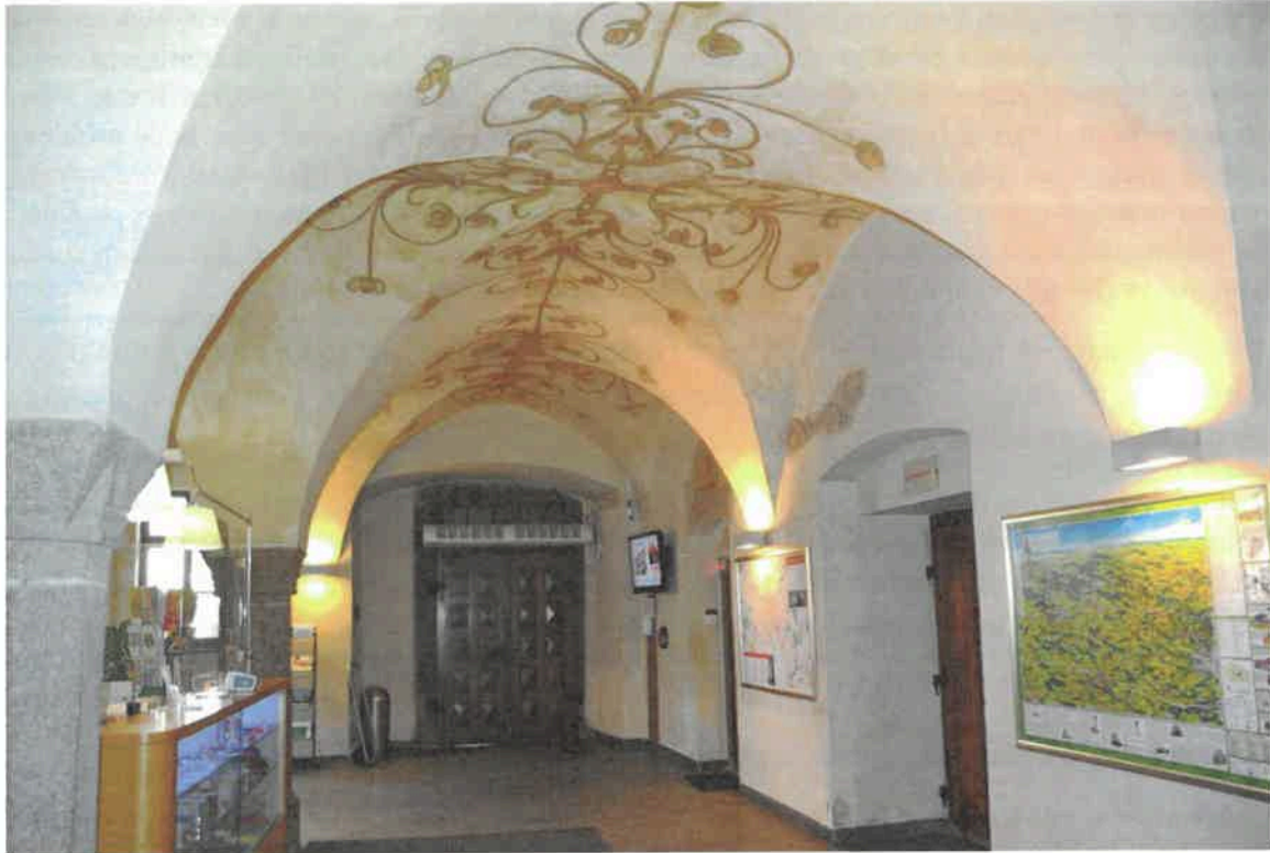
1. Celkový pohled do haly. V nižších částech omítek jsou znatelná poškození.
