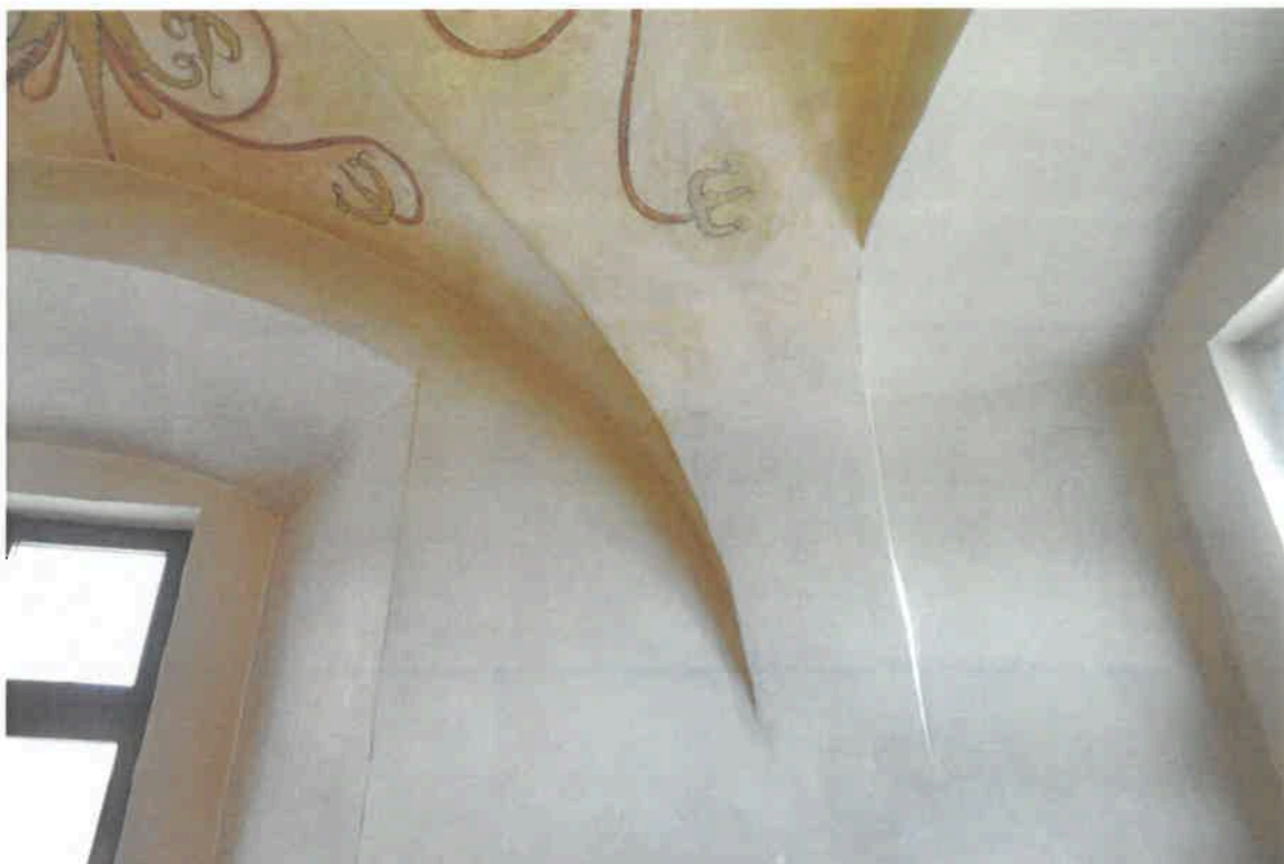
3. Na povrchu dekorativní malby leží prachové deponenty, barevná vrstva působením vzdušné vlhkosti lokálně změnila barevnost.
