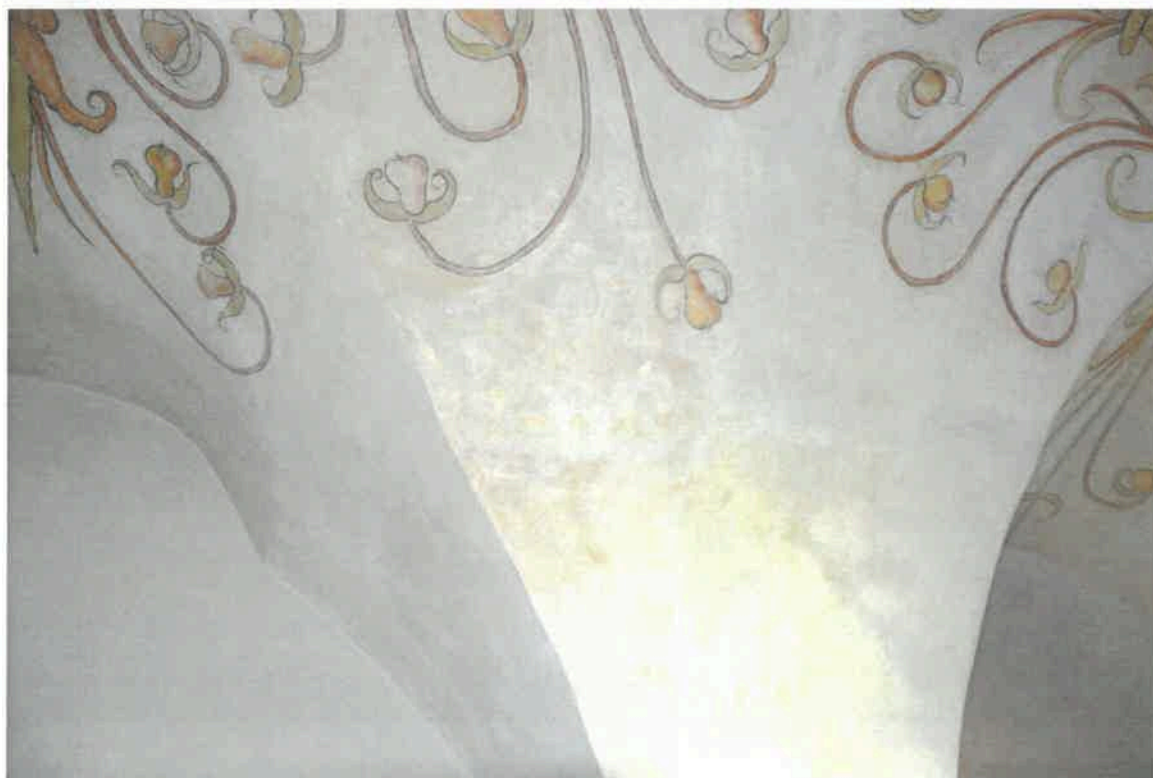
18. Barevná vrstva poškozená vlhkostí. Vznikly rozdílné barevné odstíny.
