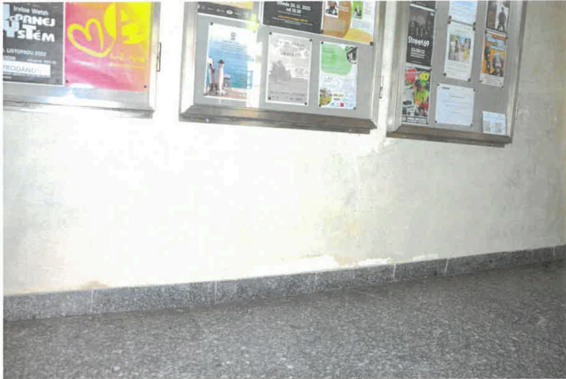
5. Omítka a barevná vrstva vykazuje poškození nad mramorovým soklíkem.
