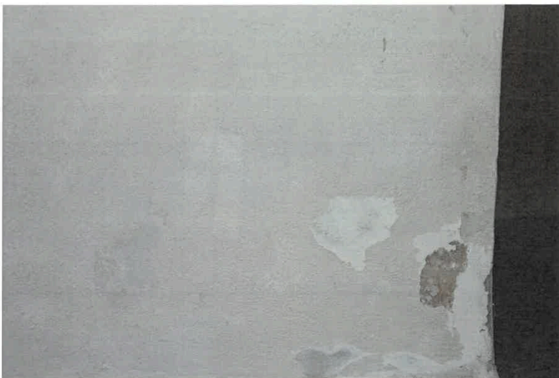
13. Destruovaná omítka a barva na stěně při zemi.
