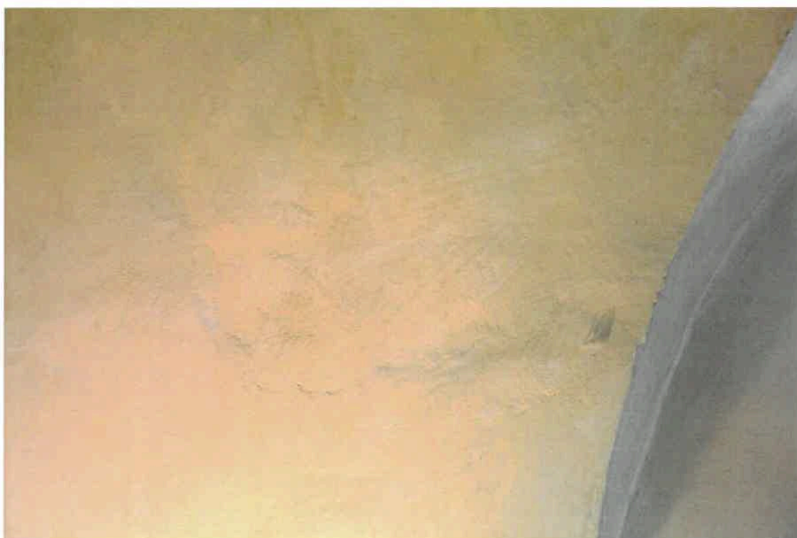
14. Uvolněná omítka před destrukcí. Barevná vrstva zpuchýřovatěla.
