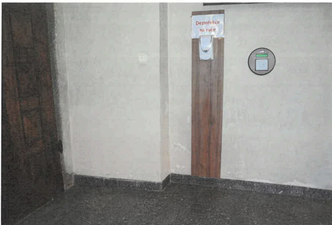
17. Poškozená barva nad soklem, lokálně provizorně vyspravena.
