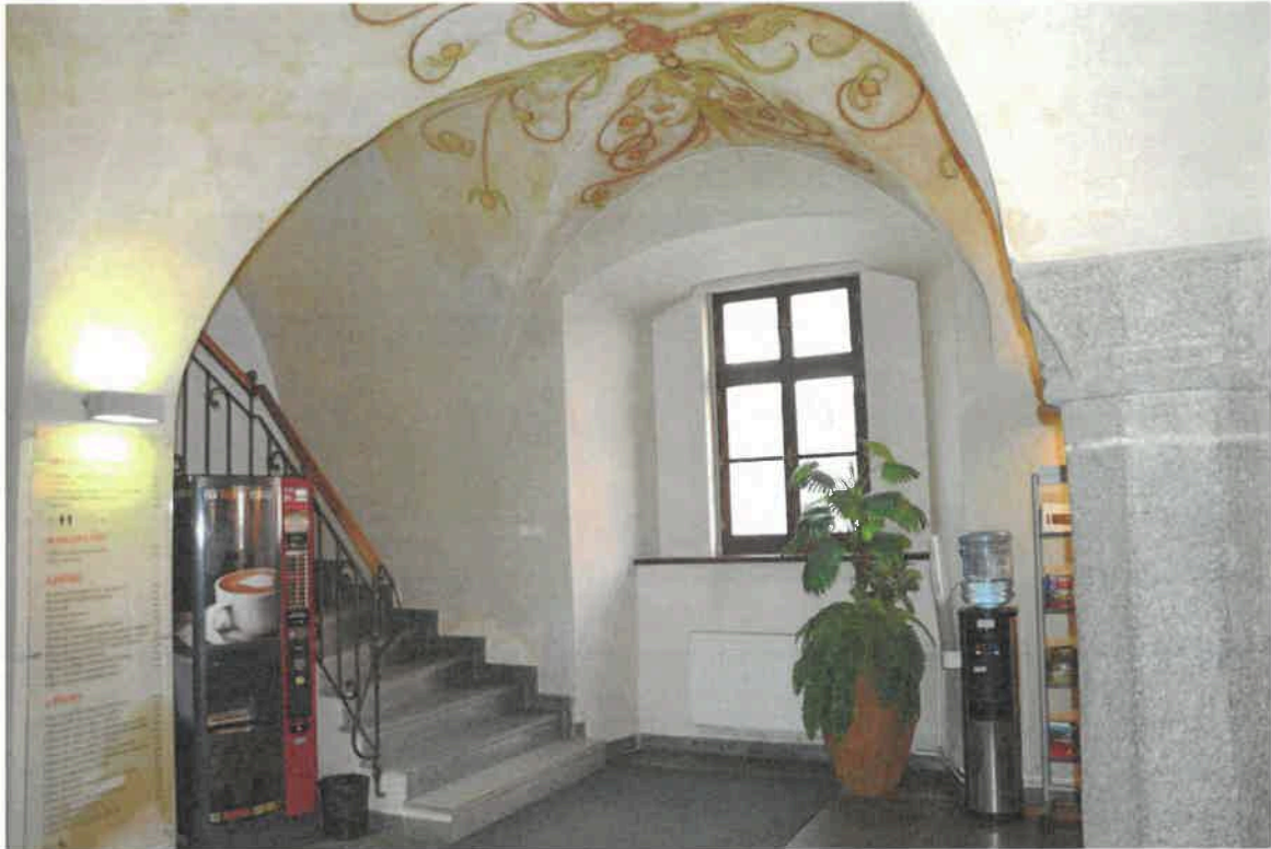
11. Lokální poškození barvy a její změny na stěnách a klenbě lze vysledovat po celé ploše.
