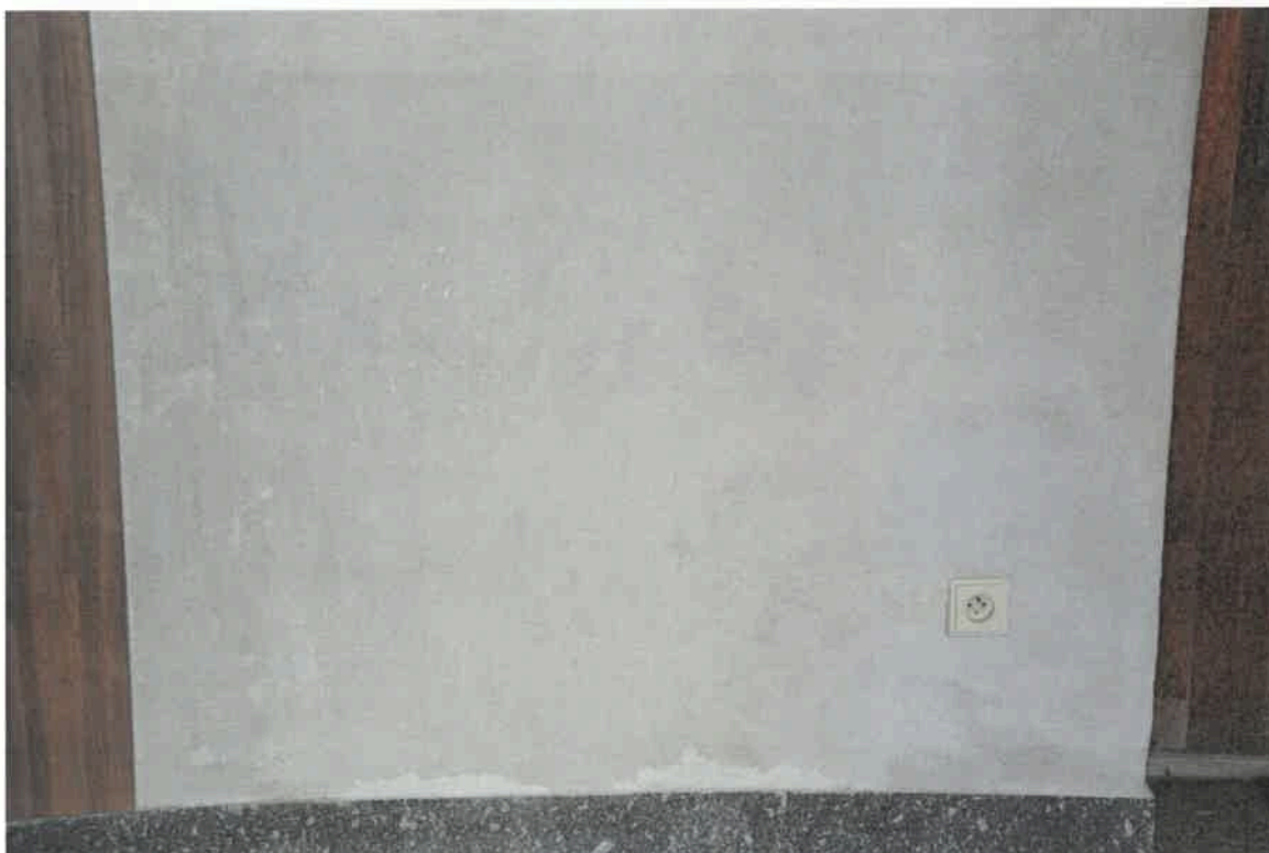
16. Poškozené a vyspravené omítky působením vlhkostí nad soklem.
