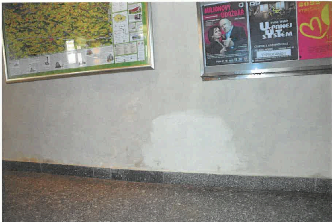
6. Lokální vyspráva a poškozená barva nad soklíkem.
