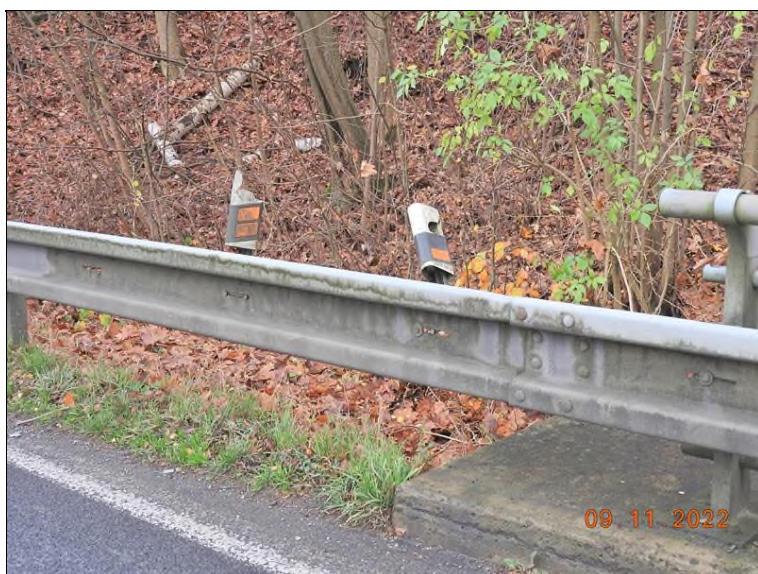
Poškozené směrové sloupky na pravé straně.
