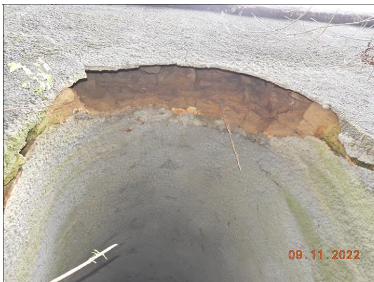
Nosná konstrukce vlevo - vypadnutá část klenby.
