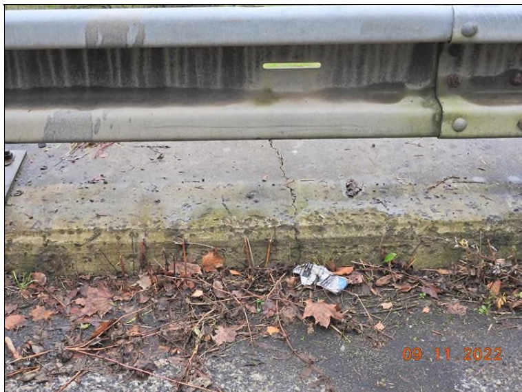
Trhlina v levé římse.
