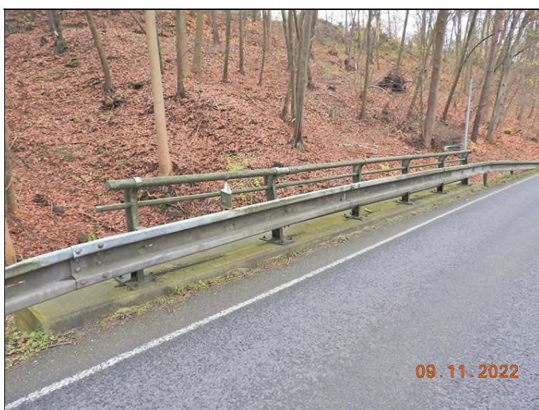
Pravá strana mostu - utržený směrový sloupek.
