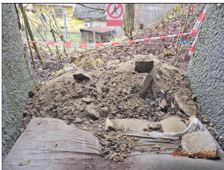
Materiál vypadnutý z nosné konstrukce.
