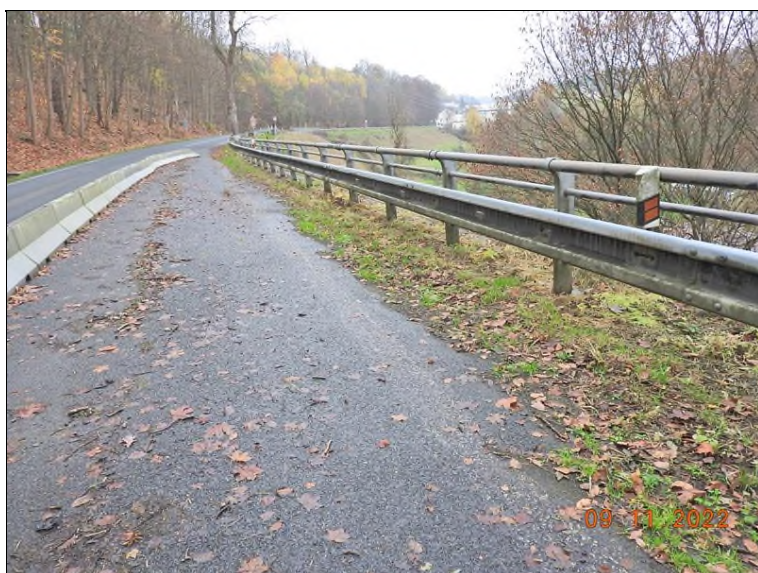
Levá strana mostu - výrazné poklesy ve vozovce.
