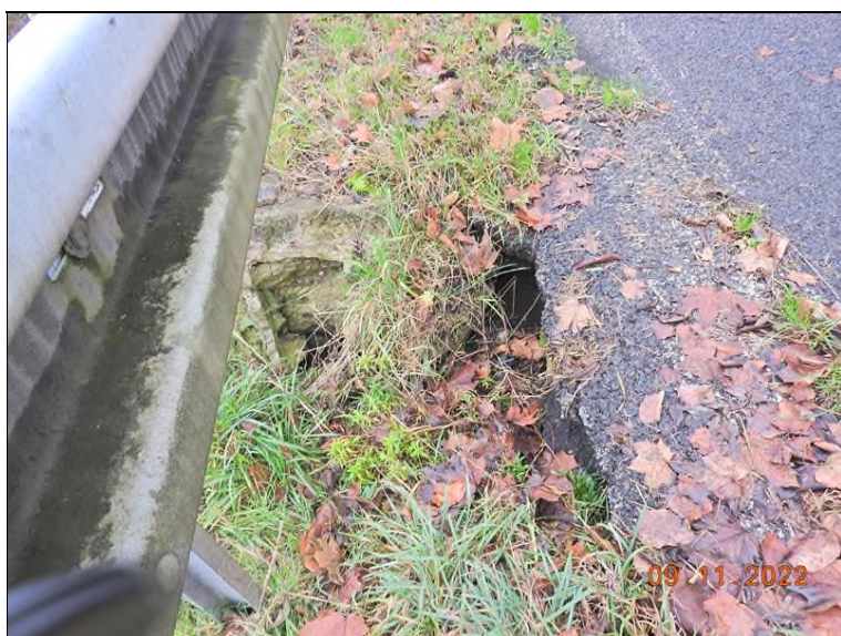
Mezera mezi levou římsou a vozovkou.
