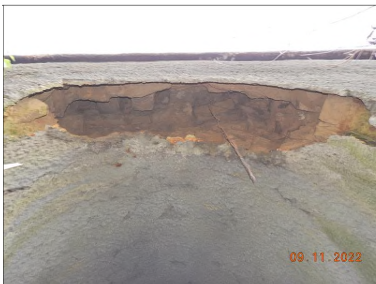
Vypadnuté kameny vlevo.
