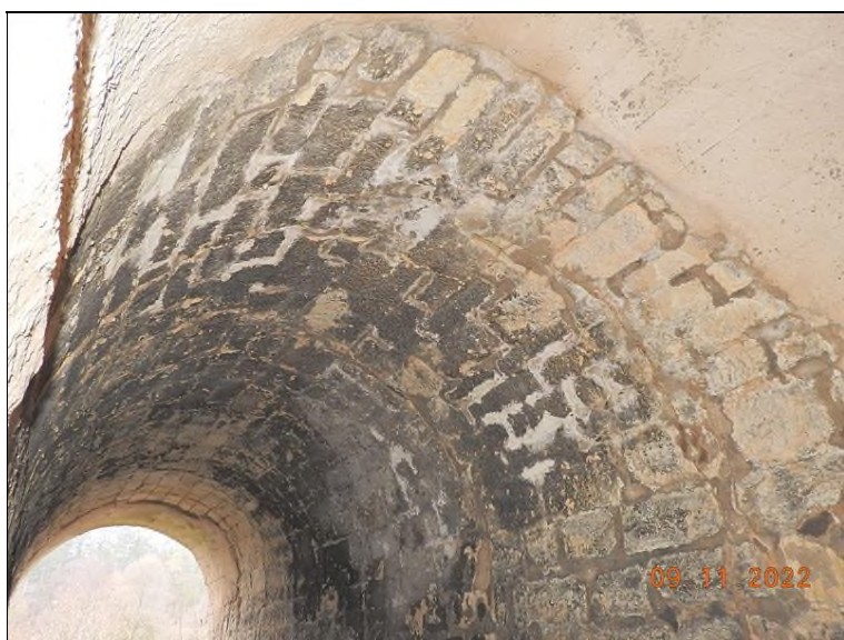
Podélné spáry v nosné konstrukci v horním patře vpravo - příčné rozevirání klenby.
