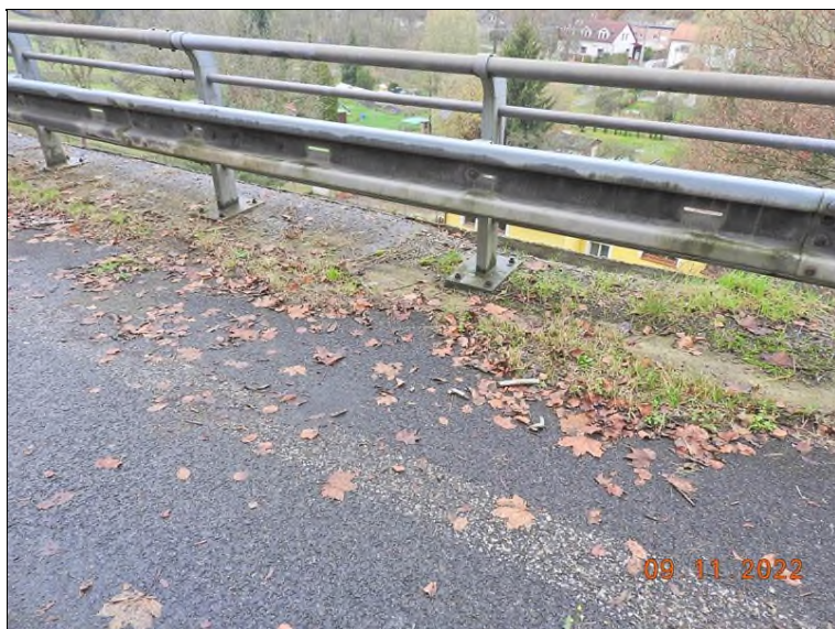
Levá strana mostu - poklesy ve vozovce.
