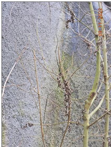
Trhlina v torkretu na rozhraní levé čelní zdi a levého křídla OP1.
