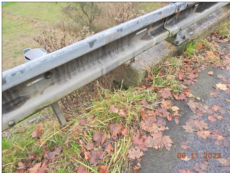
Eroze na levé straně mostu.
