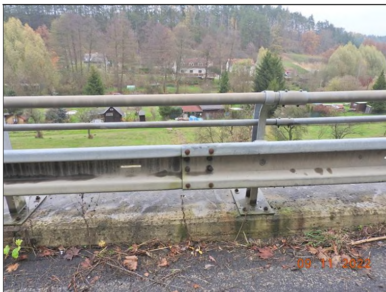
Koroze spojovacího materiálu na levé straně.
