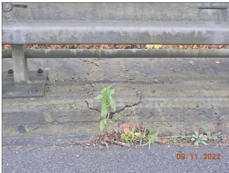
Trhlina v pravé římse.
