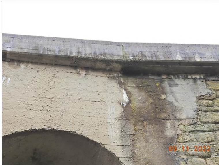
Levá římsa. Zatékání pod římsou.
