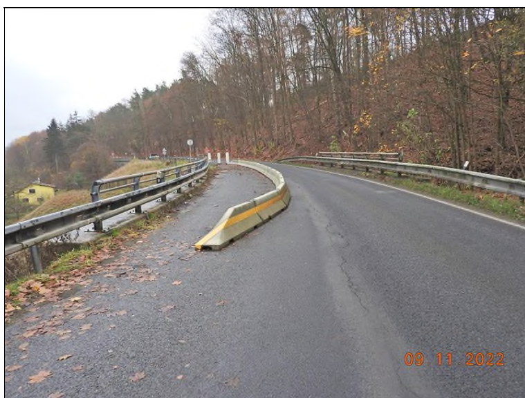
Vozovka. Výrazné poklesy ve vozovce na levé straně.
