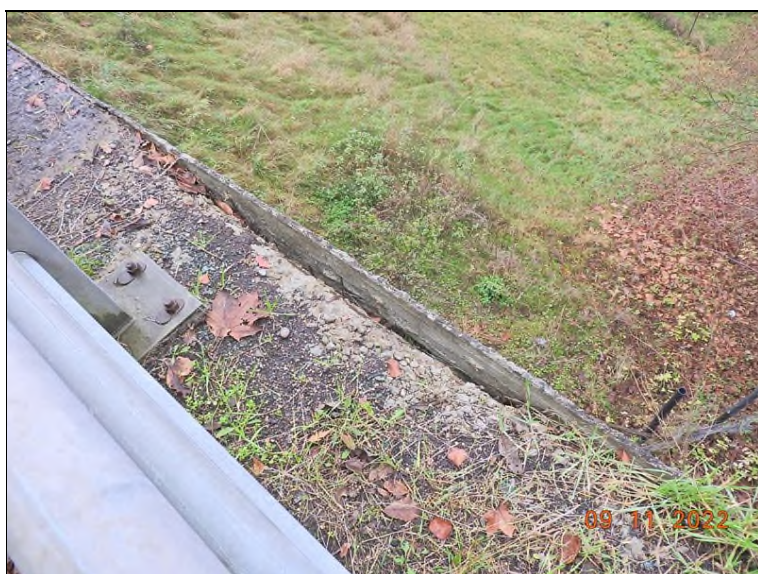
Levá strana mostu - separace boční části NK.
