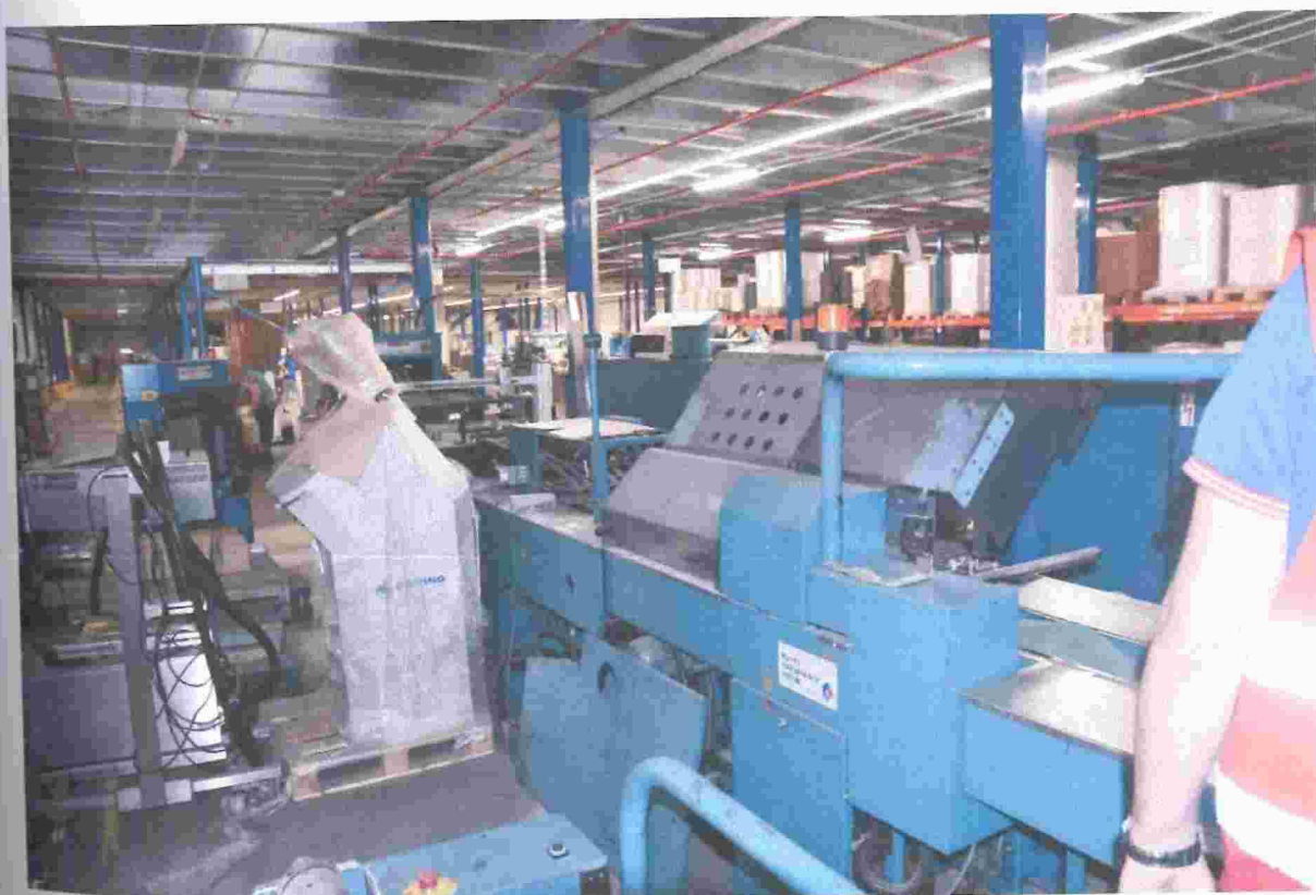
Zařízení je v částečně rozloženém stavu.
