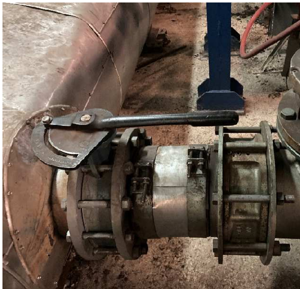
Připojení dmychadla č.2 - provizorní manžetou
