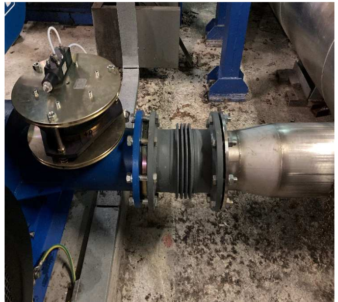
Připojení dmychadla č.4 – správné provedení
