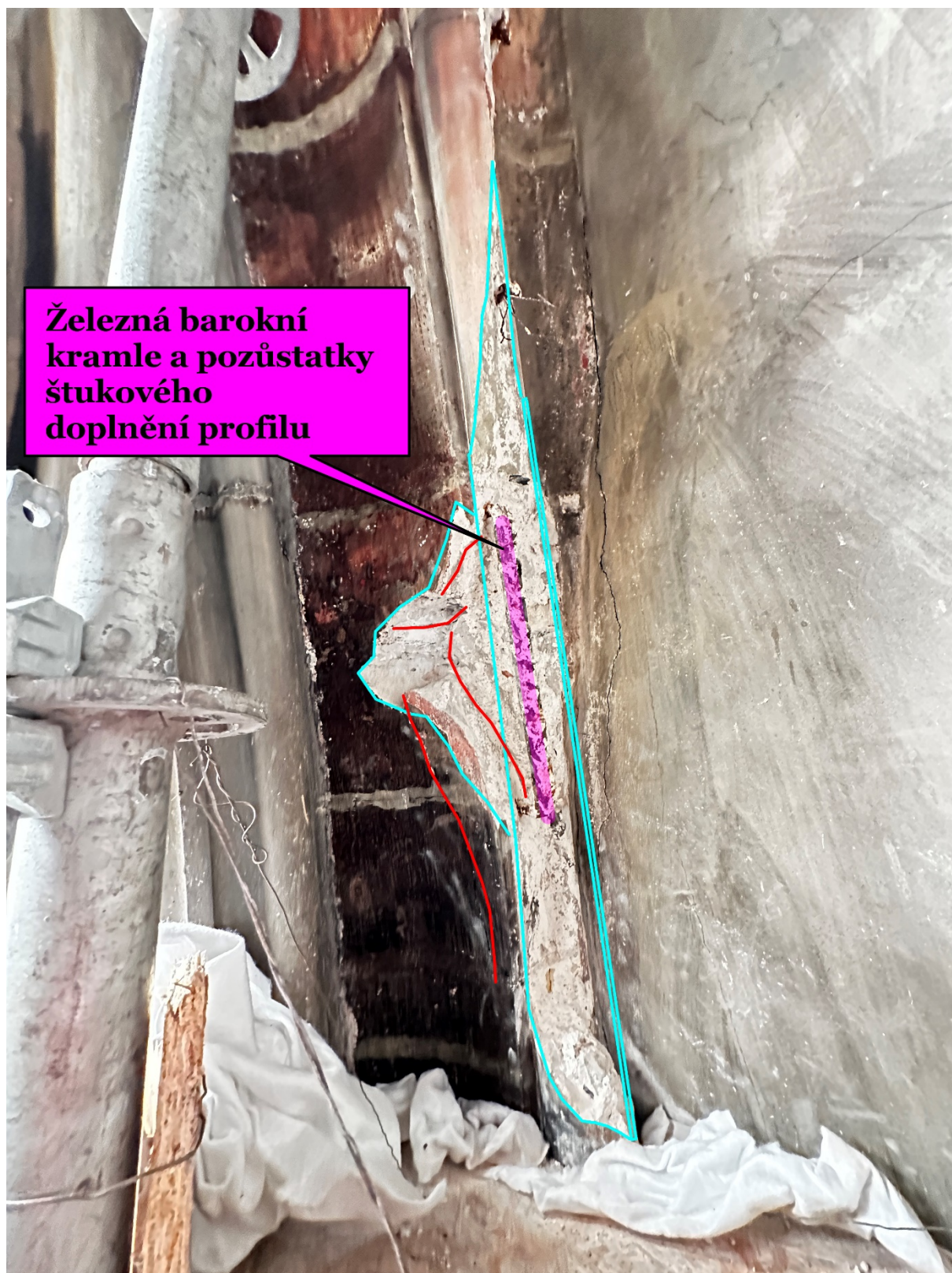
Pohled na horní poruchu v náběhu do lomeného oblouku okna. Fialově je vyznačena barokní kramle, modře chybějící profil a červeně trhliny, které jsou předmětem dalšího zkoumání.
