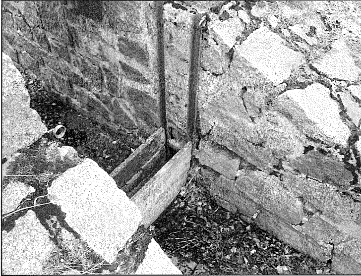
Obr. č. 5.: pohled na poruchy spárování zdiva
