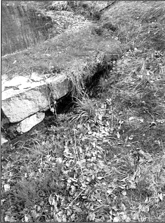
Obr. č. 3.: pohled na aktivní průsak zavázáním bezp. přelivu
