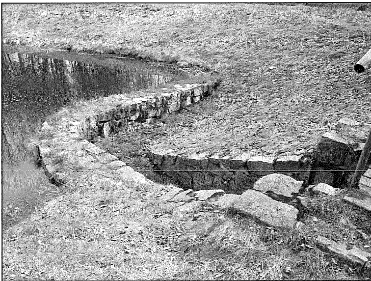
Obr. č. 2.: pohled na bezp. přeliv navržený k opravě
