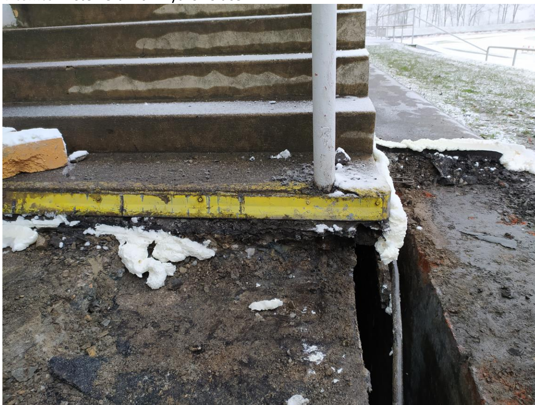
V tomto místě nefunkční hydroizolace
