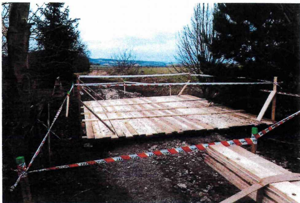
Pohled na provizorně zabezpečený propad
