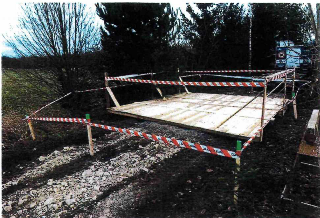
Pohled na provizorně zabezpečený propad
