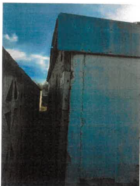
Severní fasáda – není dobrý přístup
