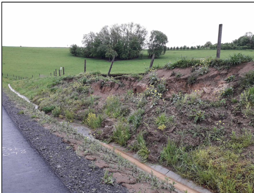
Obrázek 1 Pohled na svahové deformace na začátku zářezu vlevo C116 (cca km 0.500) (stav 23.5.2019)
