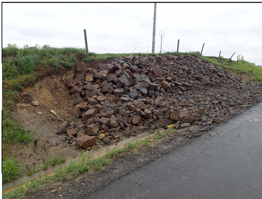
Obrázek 2 Pohled na sanovanou část zářezu pod sloupem vysokého napětí v km 0.550 (stav 23.5.2019)
