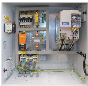
obrázek - rozvodná schránka, hlavní vypínač, vnitřní část schránky
