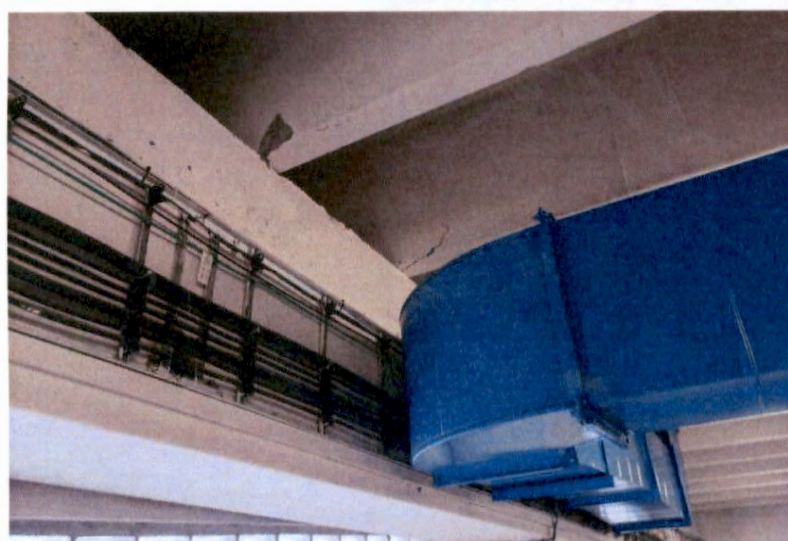
poruchy stojin desek pod horním MZ
