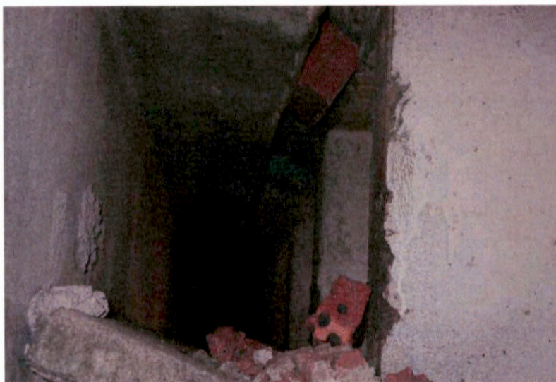
uvolněné části konstrukcí v oblasti horního MZ
