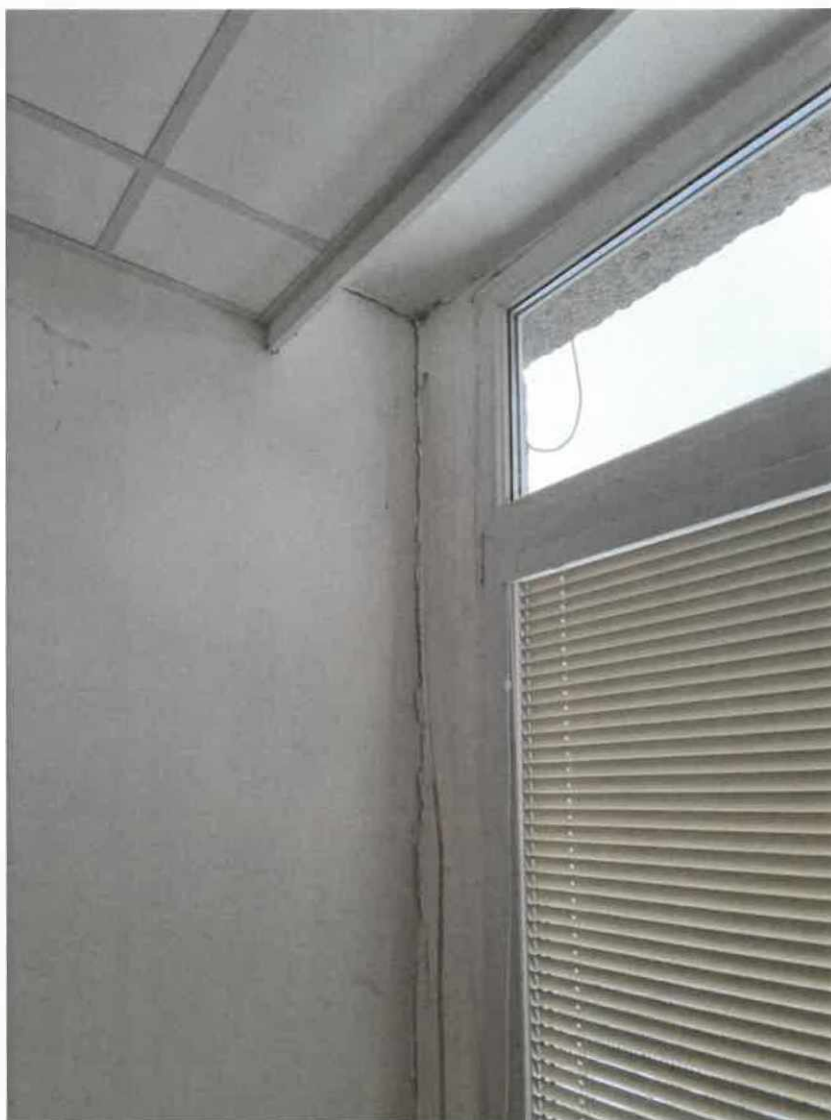
Foto 03 – pohled na prokreslení vyklonění stěny ze strany interiéru
