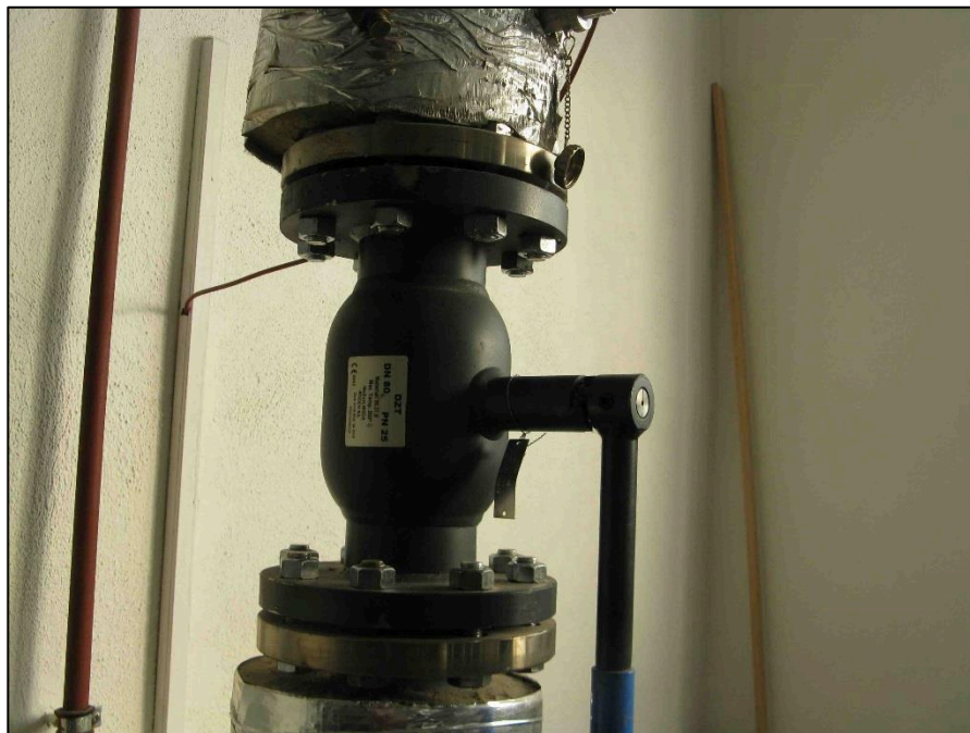
Obr.č. 3 Pohled na uzavírací ventil teplé vody DZT Broen SA DN 80, PN 16
