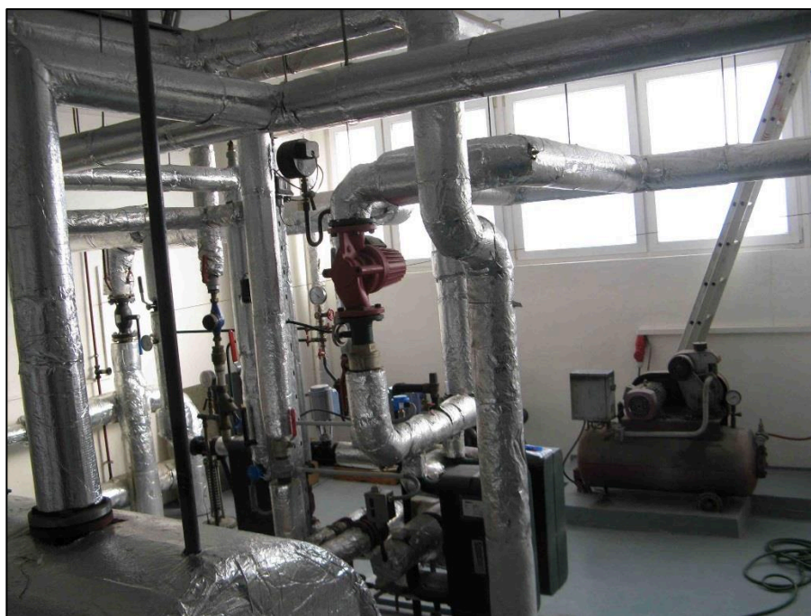
Obr.č. 16 Pohled na izolované potrubní systémy výměňkové stanice
