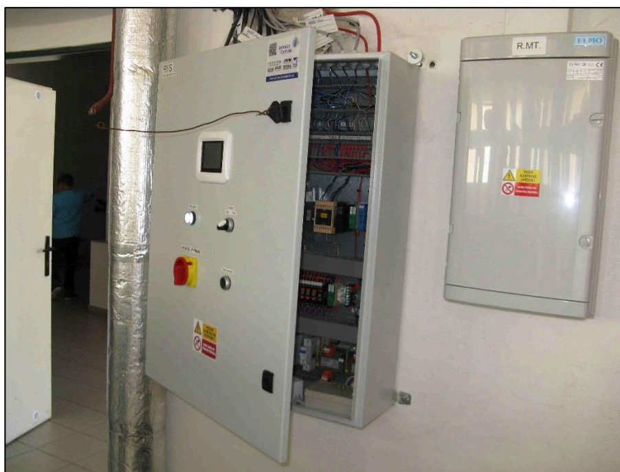
Obr.č. 14 Pohled na skříň MaR
