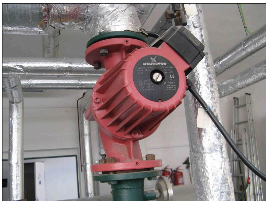
Obr.č. 6 Oběhové čerpadlo TV GRUNDFOS UPS 80 – 120 2 F
