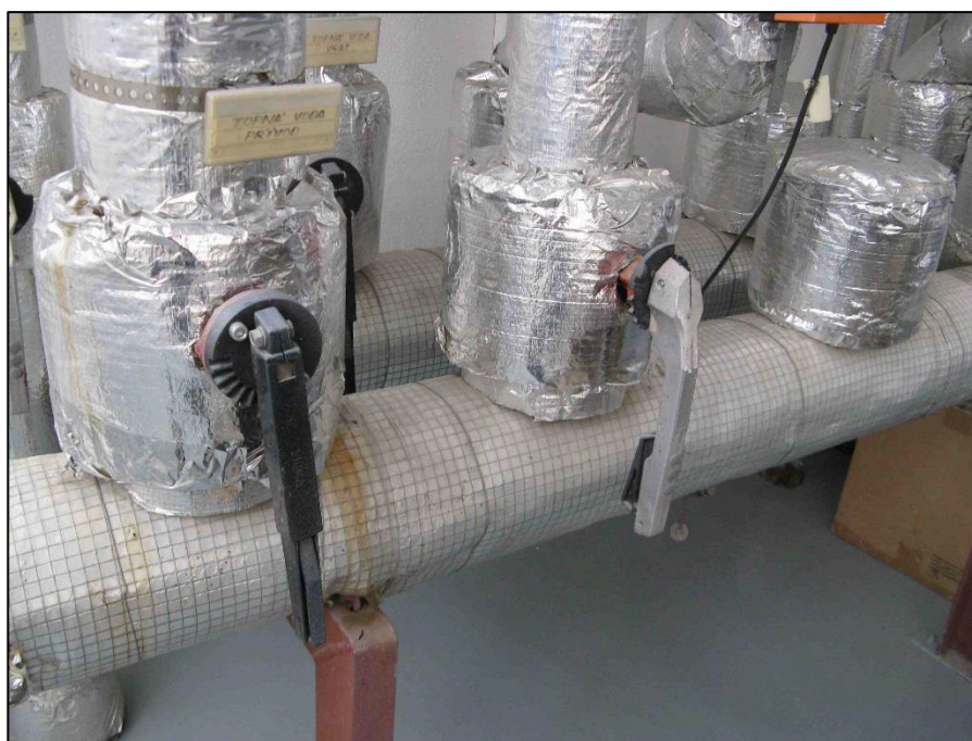
Obr.č. 12 Pohled na rozdělovač topné vody s uzavíracími klapkami
