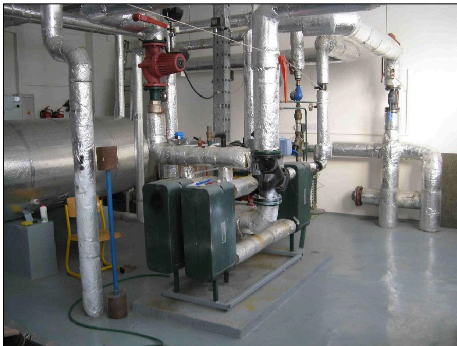
Obr.č. 1 Pohled na technologická zařízení výměňkové stanice – výměňkový blok
