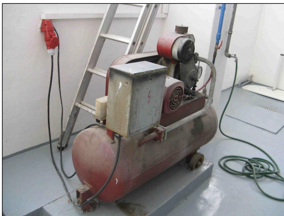
Obr.č. 8 Kompresorová stanice – kompresor 1 JSK 75 - 15 s nádobou o objemu 150 l
