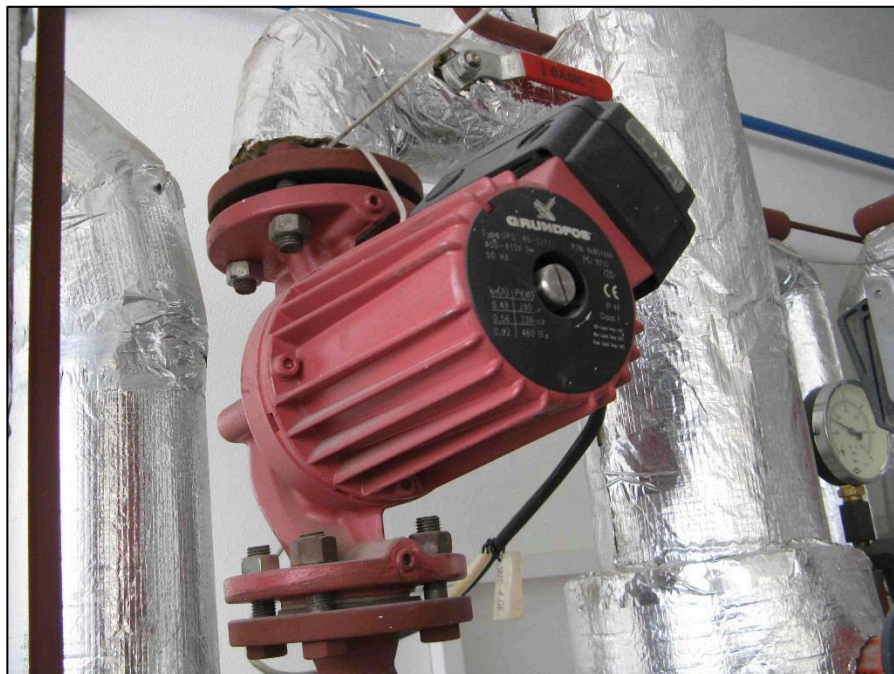
Obr.č. 11 Pohled na oběhové čerpadlo TV GRUNDFOS UPS 40 – 120 2 F
