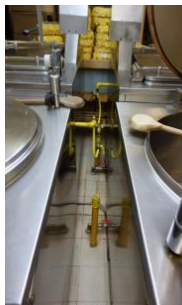
Obrázek 16 – Plynový kotel a detail připojení – rozvody plynového potrubí
