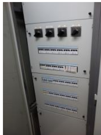
Obrázek 37 – Elektrické vedení – Pohled na rozvodnou pojistnou skříň pro kuchyň
