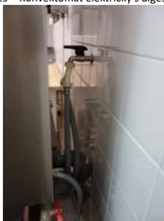
Obrázek 20 – Kulový kohout pákový – hlavní přívod vody do elektrického konvektomatu
