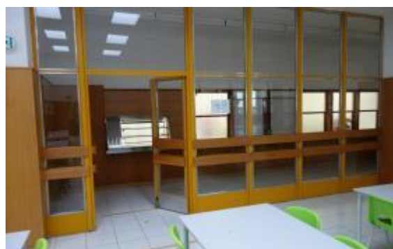
Obrázek 33 – Pohled z jídelny – bude odstraněno obložení a dále budou odstraněny skleněné stěny
