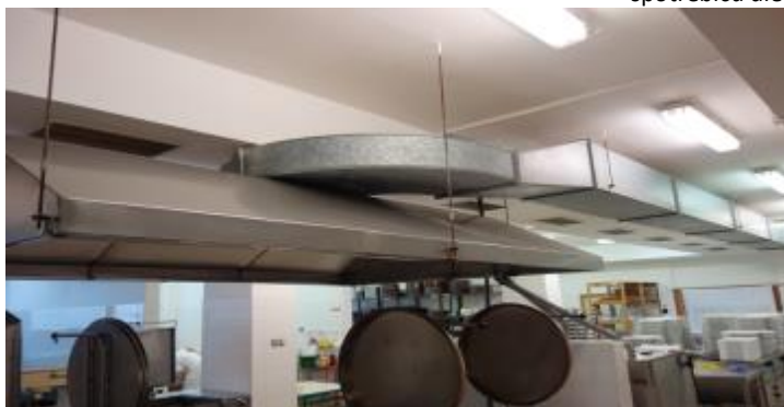
Obrázek 14 – Stávající rozvody vzduchotechniky pro technologie kuchyně, bude měněno s novou dispozicí spotřebičů dle Studie
