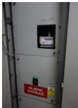
Obrázek 35 – Elektrické vedení – Hlavní vypínač elektrické energie, pohled na elektroměrnou skříň pro kuchyň
