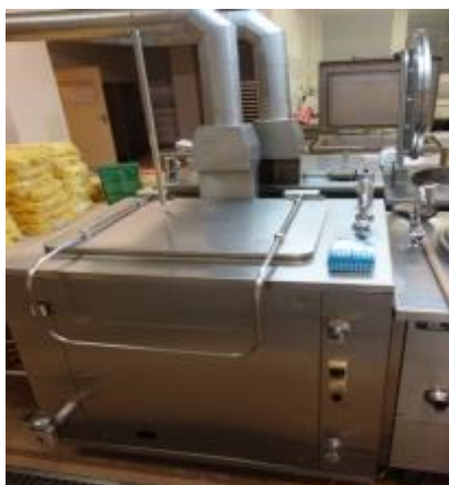
Obrázek 6 – Pohledy do kuchyně – plynové kotle, bude měněno dle Studie za elektrické kotle vč. dispozice dle Studie
