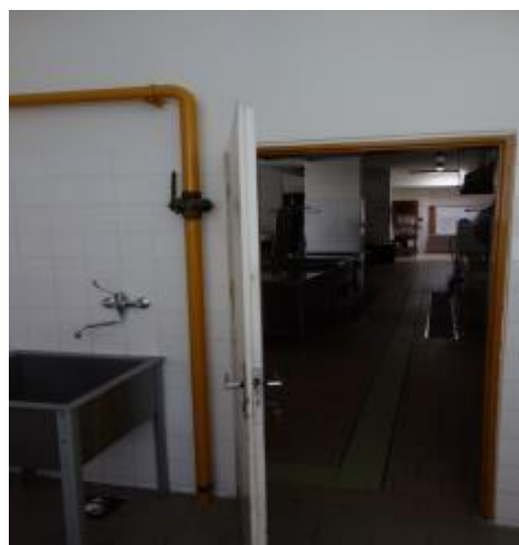
Obrázek 43 – Hlavní uzávěr plynu je součástí prostor kuchyně
