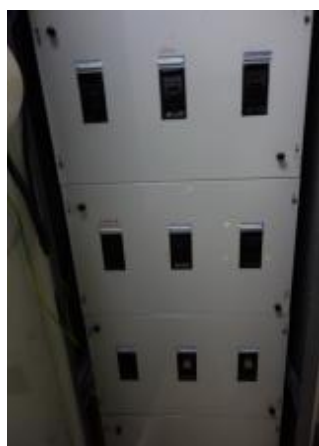
Obrázek 38 – Elektrické vedení – Pohled na rozvodnou pojistnou skříň pro kuchyň
