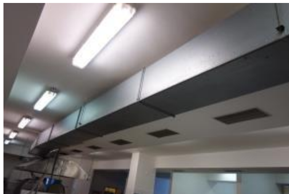
Obrázek 13 – Stávající rozvody vzduchotechniky pro technologie kuchyně, bude měněno s novou dispozicí spotřebičů dle Studie
