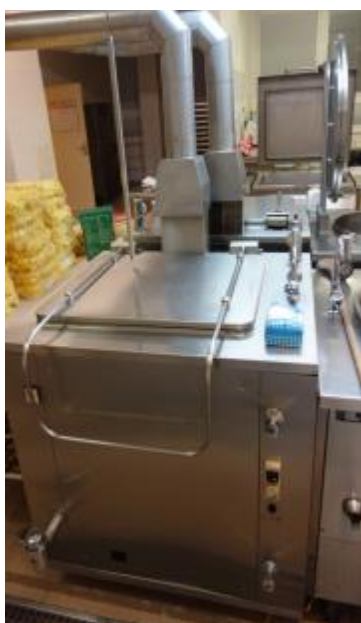
Obrázek 15 – Plynový kotel a detail připojení – plynové kotle budou odstraněny, budou instalovány plynové konvektomaty s novou dispozicí dle Studie
