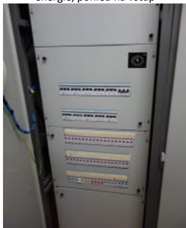
Obrázek 36 – Elektrické vedení – Pohled na rozvodnou pojistnou skříň pro kuchyň
