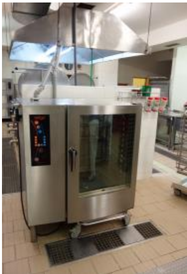
Obrázek 17 – Konvektomat elektrický s digestoří - bude měněn za nový konvektomat vč. dispozice za plynový dle Studie, digestoř bude měněna vč. rozvodů de Studie
