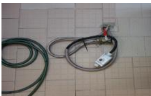
Obrázek 10 – Detail napojení kotle na zdroj elektřiny v zemi
