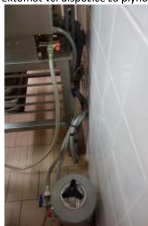
Obrázek 21 – Kulový kohout motýl – přívod vody pro spršku do elektrického konvektomatu
