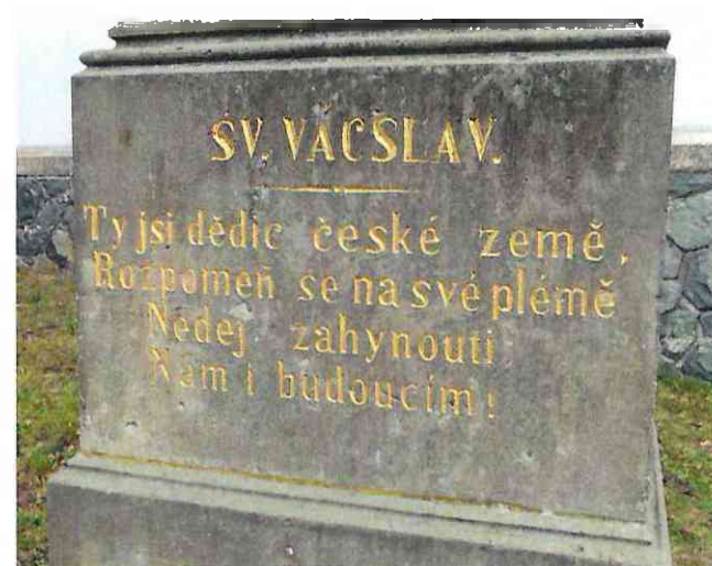
Foto 4 Čelní nápisová část, zlacení bylo provedeno bez podkladové vrstvy a na mnoha místech je narušeno. Zlacení bude proto zapotřebí provést znovu.
