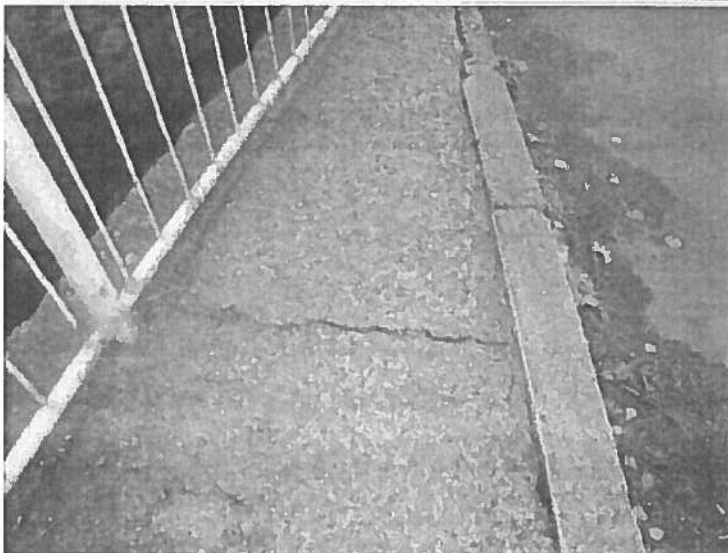
Beton říms - trhлина
