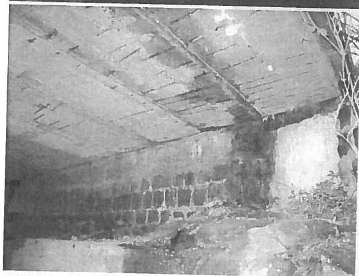
OP 1 - zatékání a prahy, zatékání do spáry NK, koroze výztuže NK
