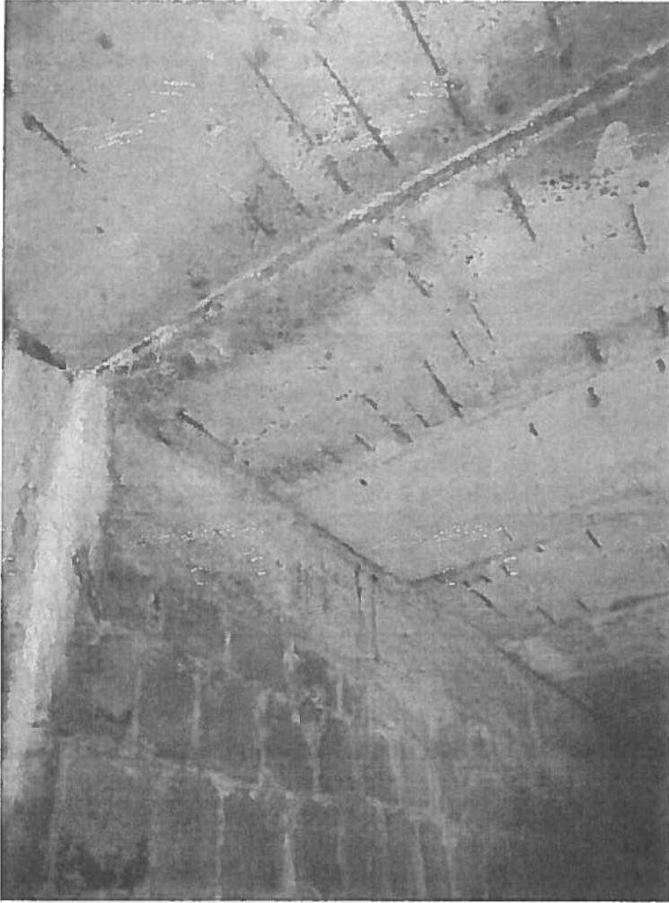
zatékání do spáry NK, koroze výztuže NK
