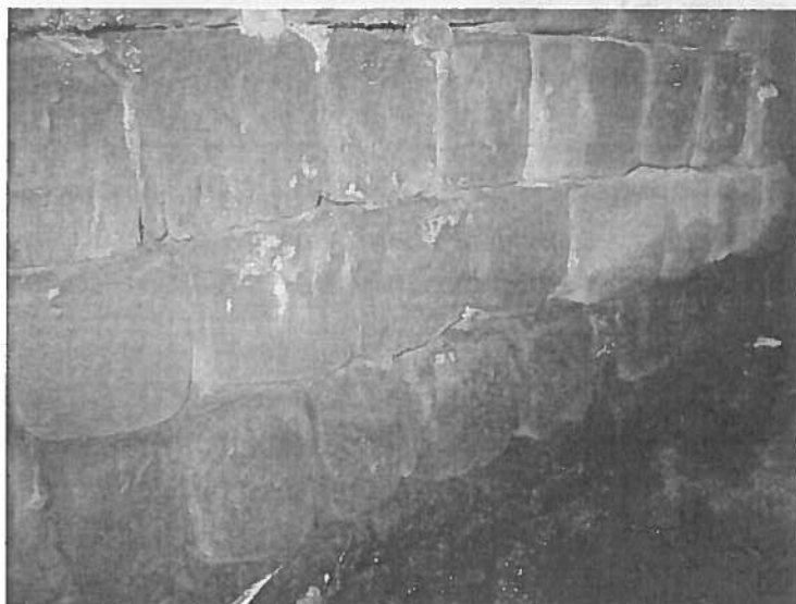
OP2 - vyplavené spárování
