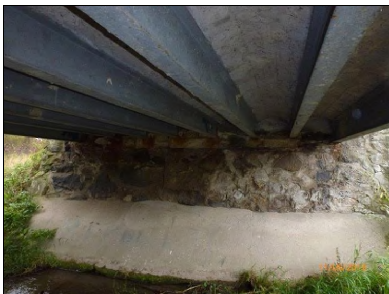
Podhled NK ve 2. poli a pohled na líc OP3, na líci opěry jsou patrné v místech uložení nosníků stopy koroze.
