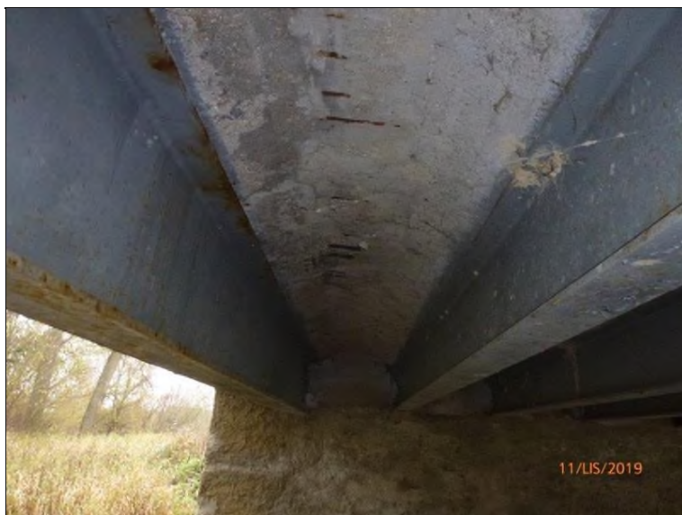
Obnažená korodující výztuž desky mostovky (1. pole - levý okraj).
