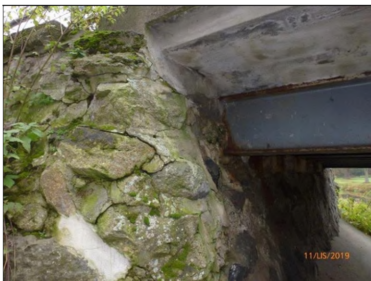
Křídlo u opěry 3 vlevo - poruchy spárování zdiva.
