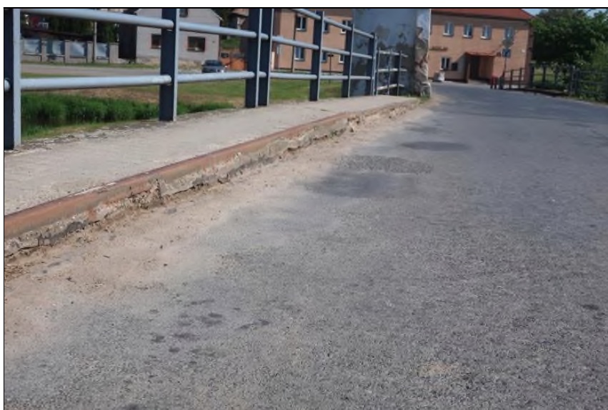
degradace betonu na vnitřním boku obruby pod ocelovým úhelníkem
