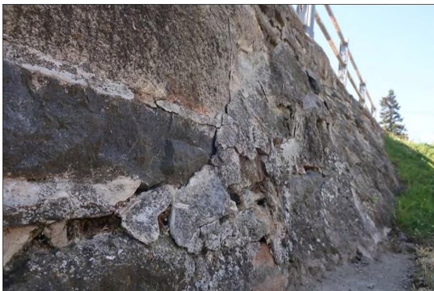
detail poruch spárování zdiva na líci pravého křídla O4
