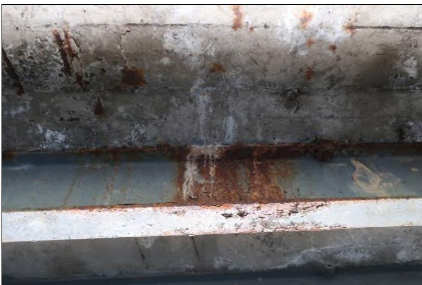
výluhy pojiva a intenzivní koroze stojiny nosníku v místě průsaku NK
