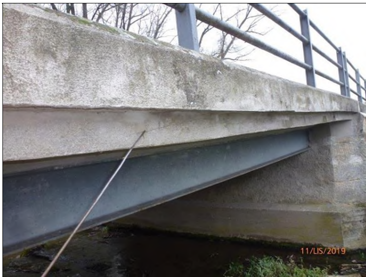
Podélná trhlinka na sanovaném pravém boku konzoly NK od korozních zplodin výztuže - 1. pole.
