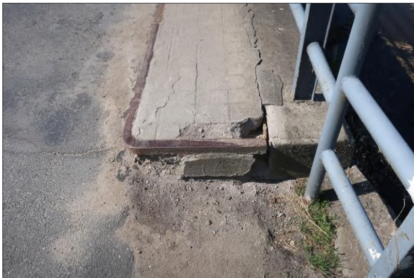
rozpad betonového krytu pravého chodníku nad O1
