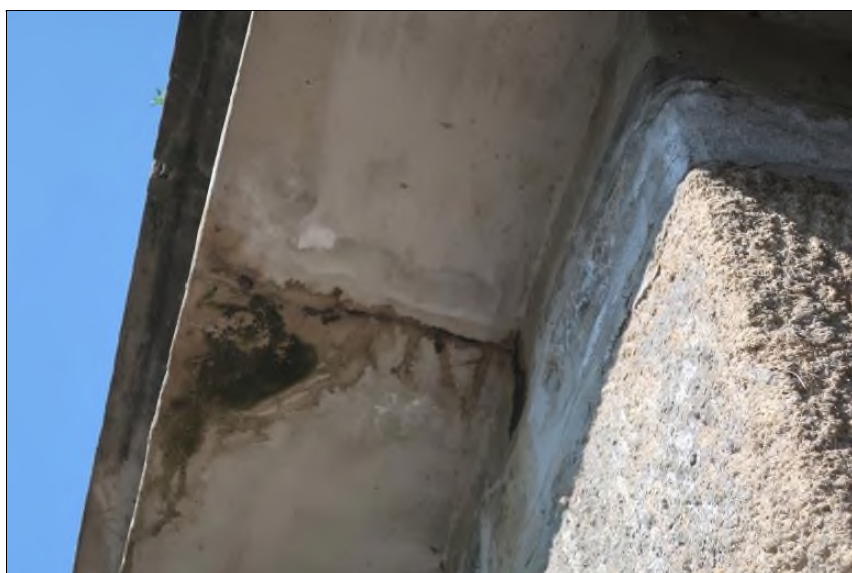
stopy po průsaku příčnou sparou v levé konzole nad P3
