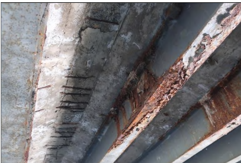
intenzivní koroze betonářské výztuže mostovky i nosníku v místě průsaku NK
