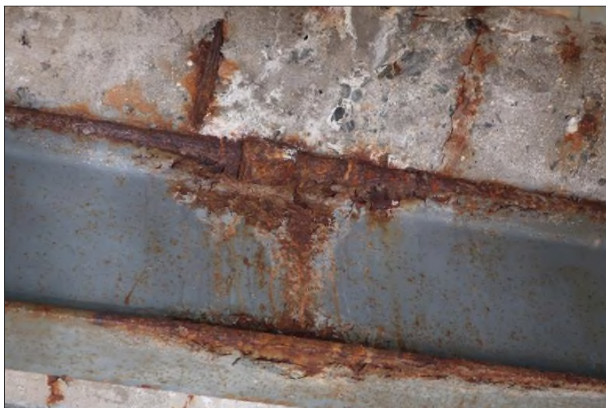
detail koroze nosníku
