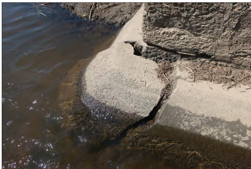
poškozené zpevnění zdiva dřívku P3 v úrovni kolísání běžné hladiny Radbuzy
