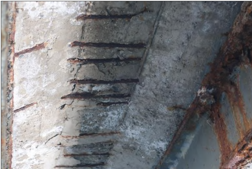
1. pole - detail korozí oslabené výztuže desky mostovky
