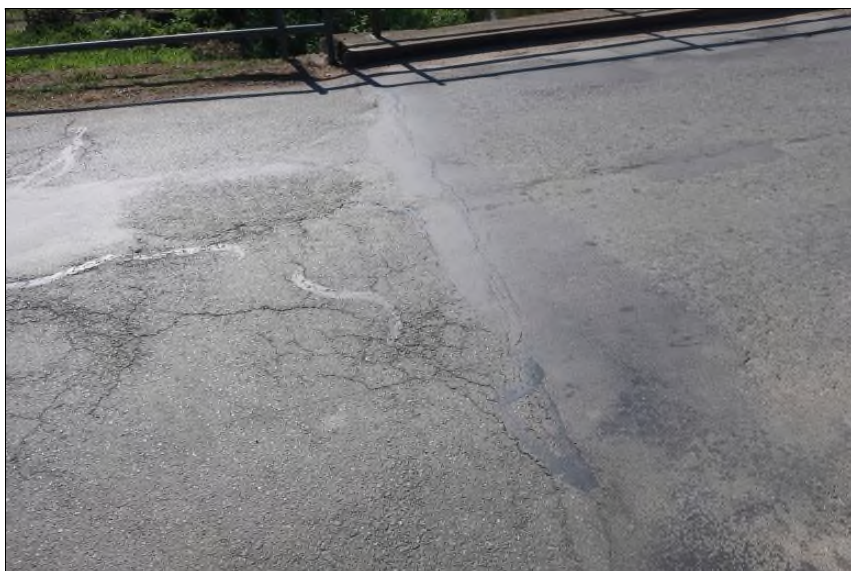
poruchy krytu vozovky na předmostí před O1
