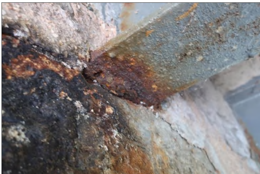
DTTO - koroze nosníku v místě vetknutí do zdiva opěry
