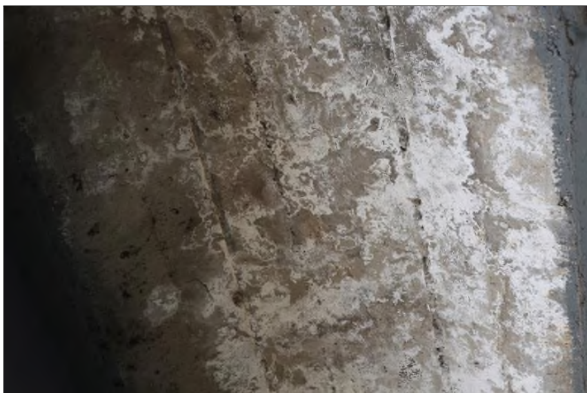
výrazné výkvěty na spodním líci mostovky
