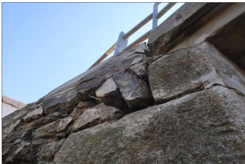
detail poruch zdiva pravého křídla O1
