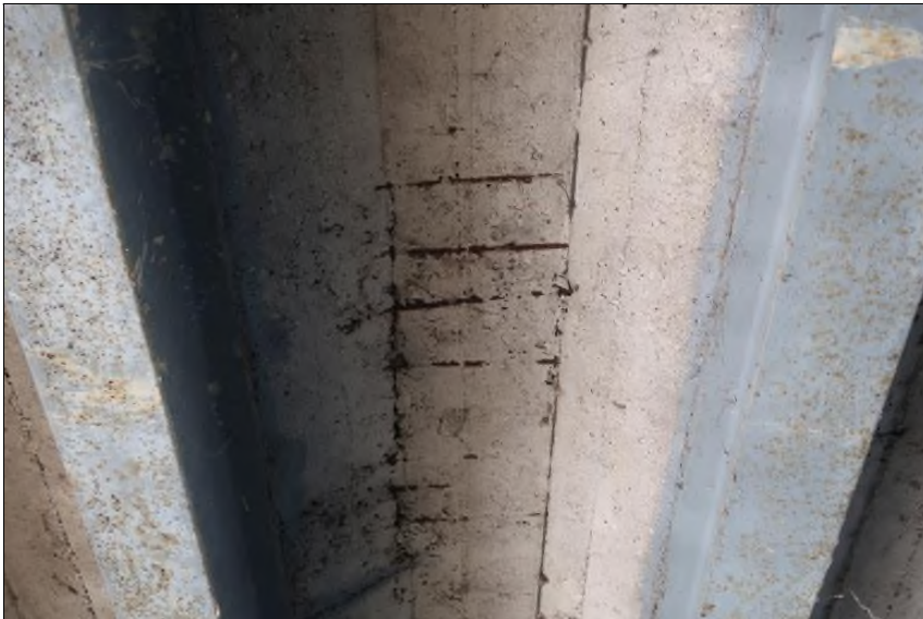
koroze výztuže desky mostovky v oblasti "nulové" tloušťky krycí vrstvy
