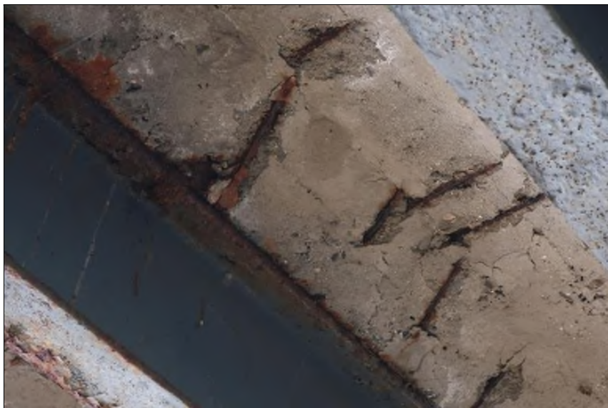
korozí oslabení betonářská výztuž desky mostovky
