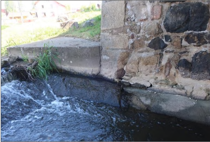
průsak zdívem dříku opěry 1
