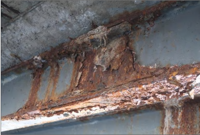
1. pole - detail korozí oslabeného nosníku
