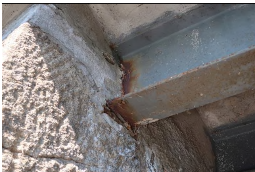
2. pole - koroze nosníku v místě vetknutí do P3
