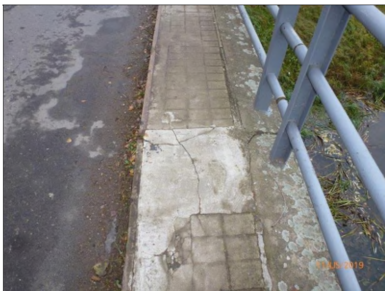
Poruchy krytu chodníku nad středním pilířem.
