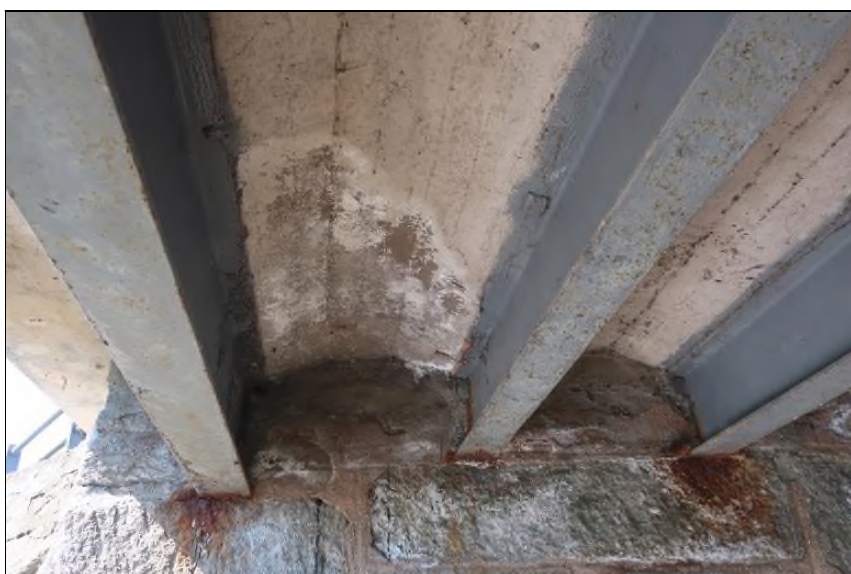
3. pole - stopy po průsaku s výkvětem na spodním líci mostovky mezi nosníky
