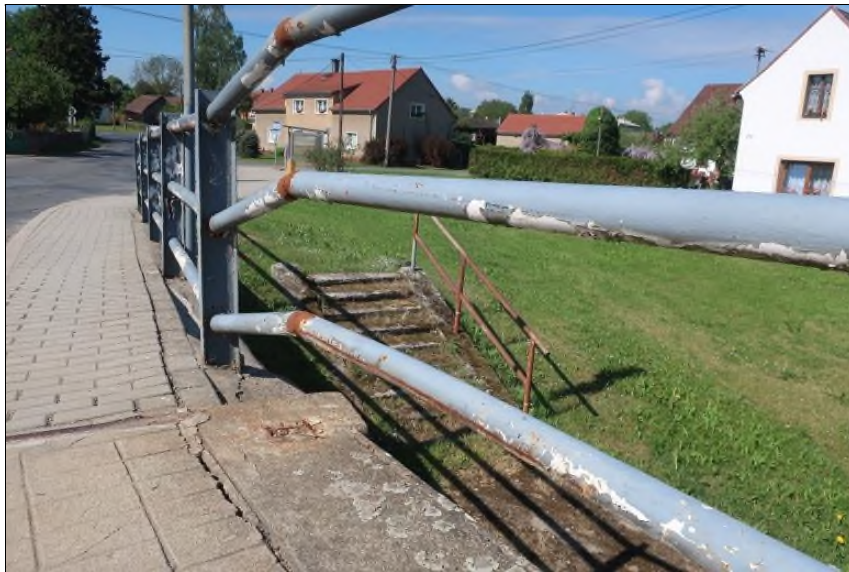
korozí madel zábradlí
