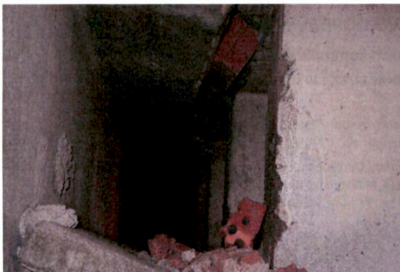
uvolněné části konstrukcí v oblasti horního MZ
