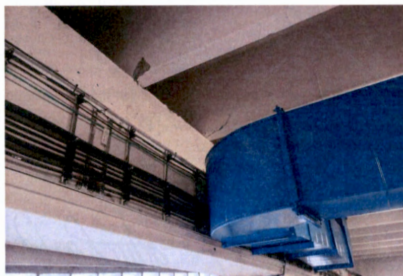
poruchy stojin desek pod horním MZ
