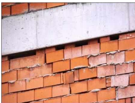
Poškození neomítnutého zdiva – obvyklý, úkryt ptáků i netopýrů
