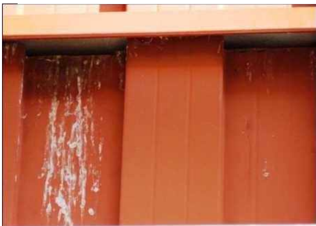
Prostor pod vletovým otvorem pěvců je často znečištěn trusem
