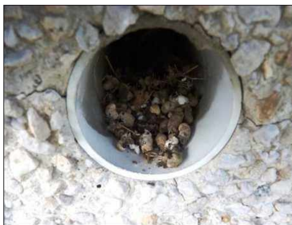
Trus drobných pěvců v ústí ventilačního otvoru
