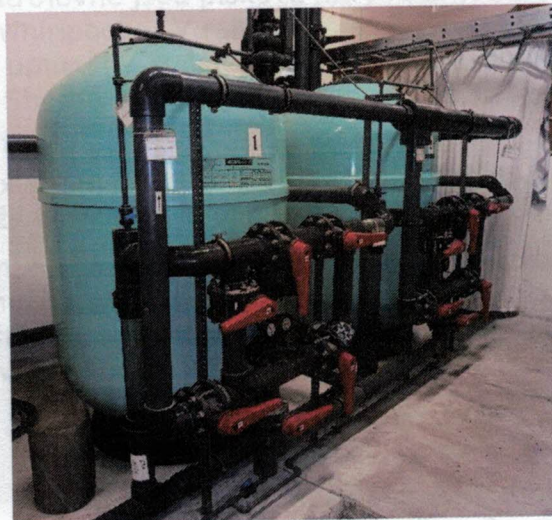
Obrázek 2: Pískové filtry rekreačního bazénu.
