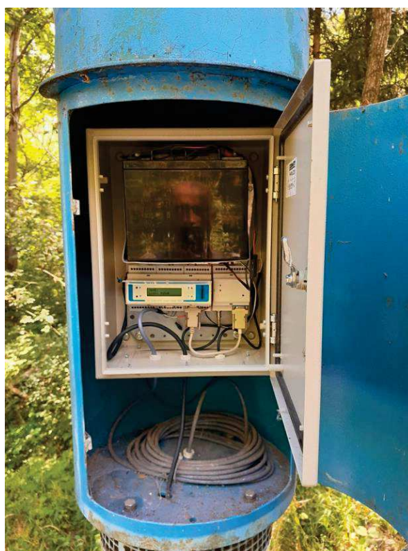
Obrázek 11 – stávající vybavení LMG Mýto
