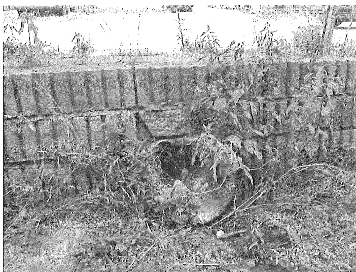
Petrůvka, střední úsek, porušená OZ, chybějící pata
