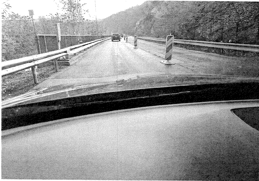
STAV PŘED OPRAVOU KM 13,190
