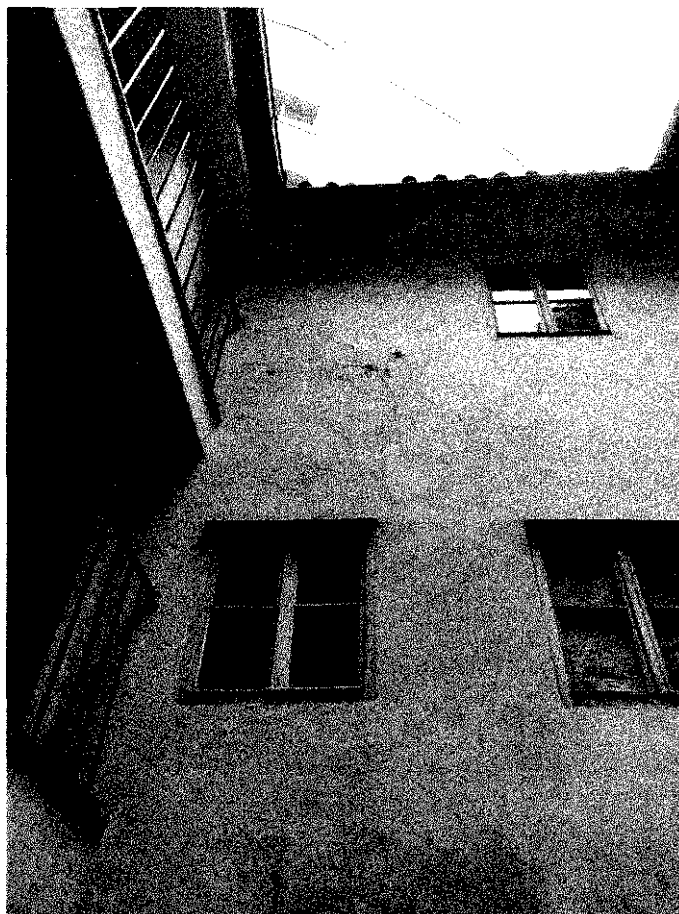
Obr. č.9. Fotodokumentace řešeného místa poruchy římsy
