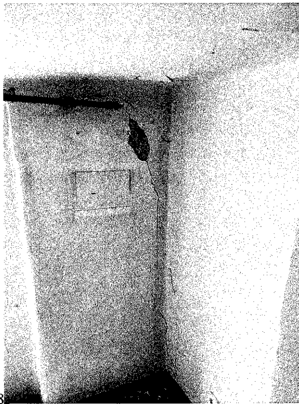
Obr. č.8. Fotodokumentace řešené praskliny ve zdivu
