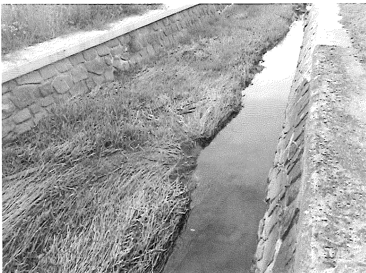
pohled do koryta vodního toku s významným množstvím sedimentů
