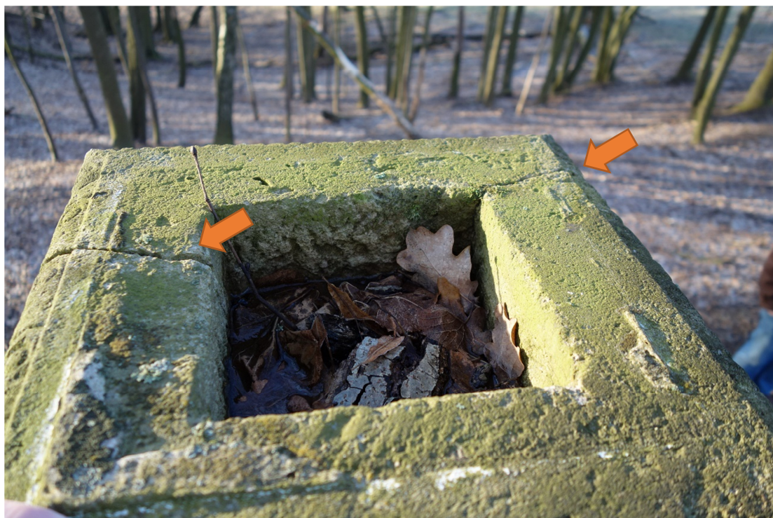
Obr. 6: Detail hlavice svrchu. Patrné praskliny po stranách. Stav 24.2.2022.
