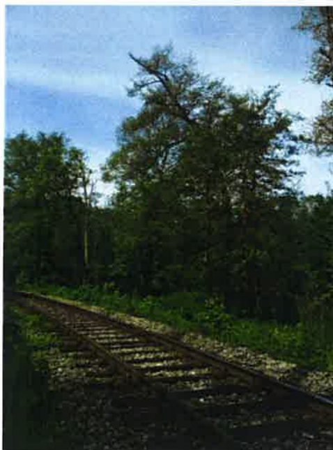
Úsek č. 1 – stromy v kolizi s železniční tratí v ř.km 19,800
