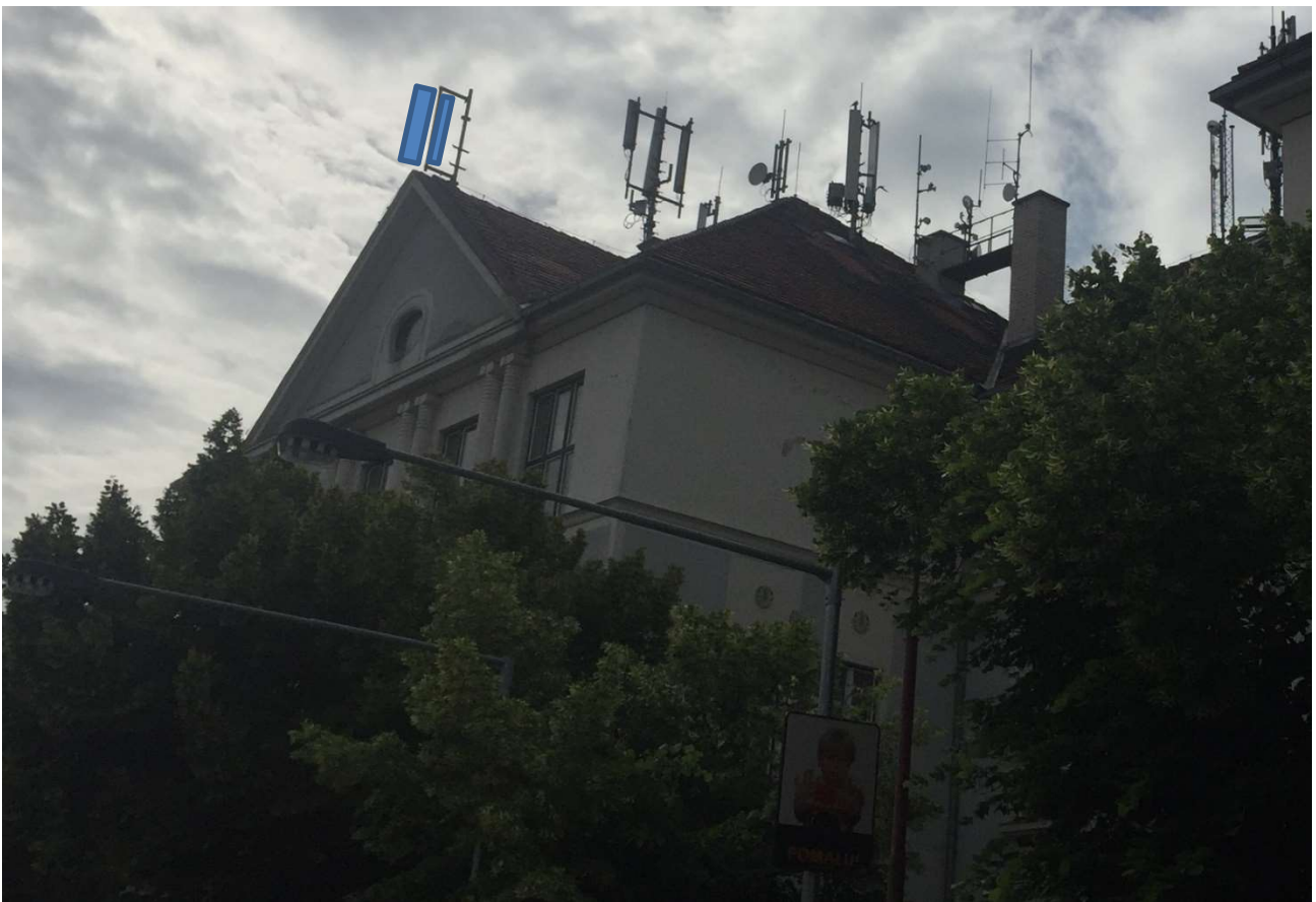
Obr. 6 Umístění antén na stožáru T-Mobile výška 30 m
