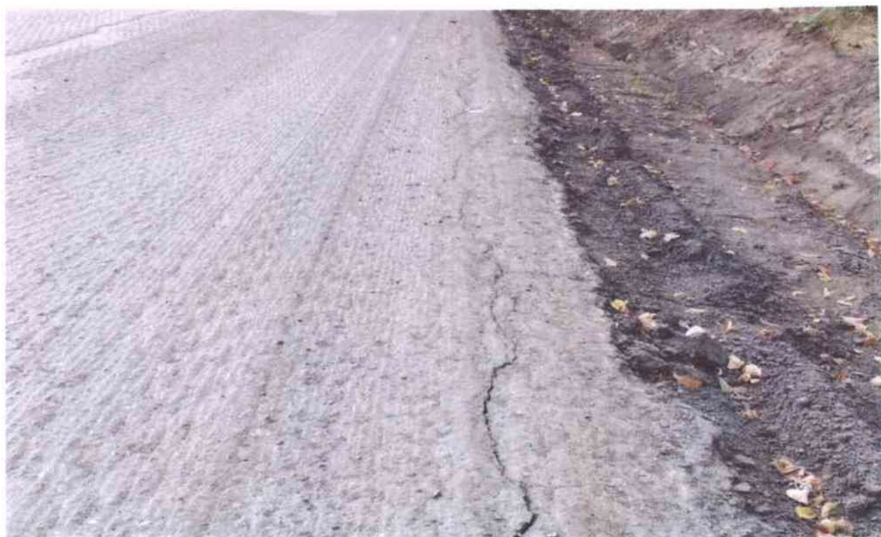
podélné praskliny po odfrézování asf. souvrství vpravo
