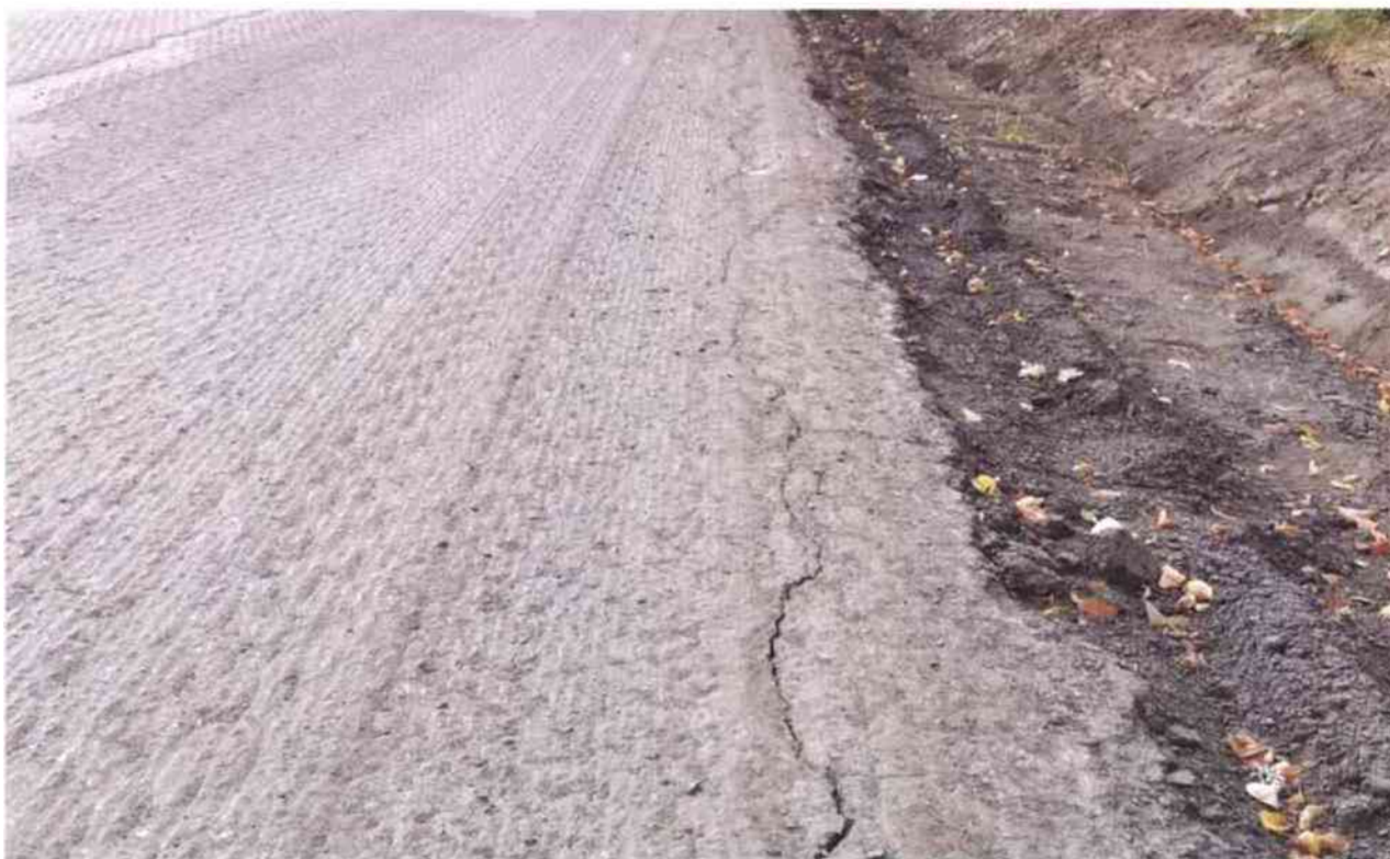
podélné praskliny po odfrézování asf. souvrství vpravo
