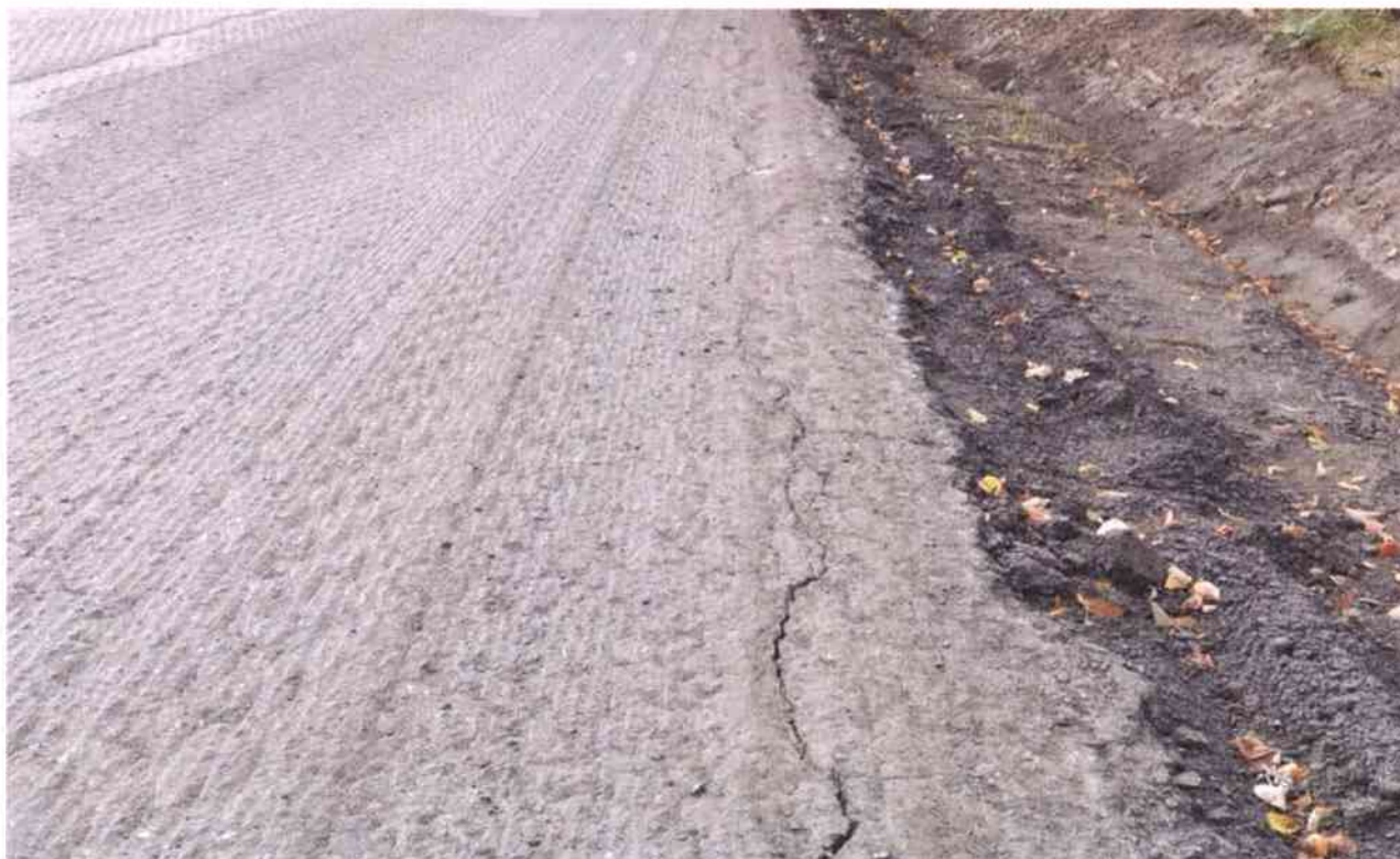
podélné praskliny po odfrézování asf. souvrství vpravo
