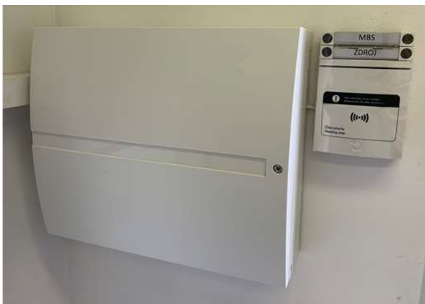
Obr. 8 – JABLOTRON ústředna JA-107K a přístupový modul JA-114E
