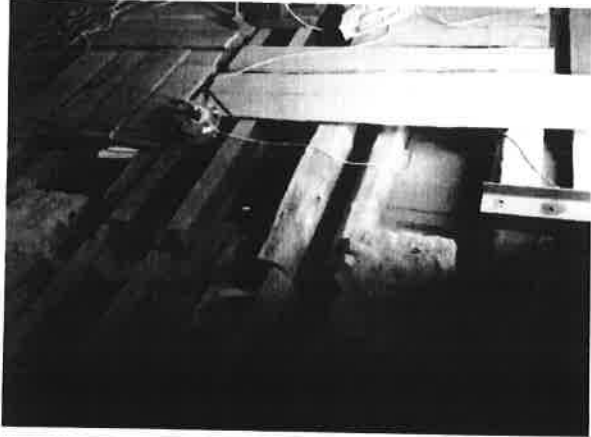
Příloha č.2: fotodokumentace Zhlaví trámů
