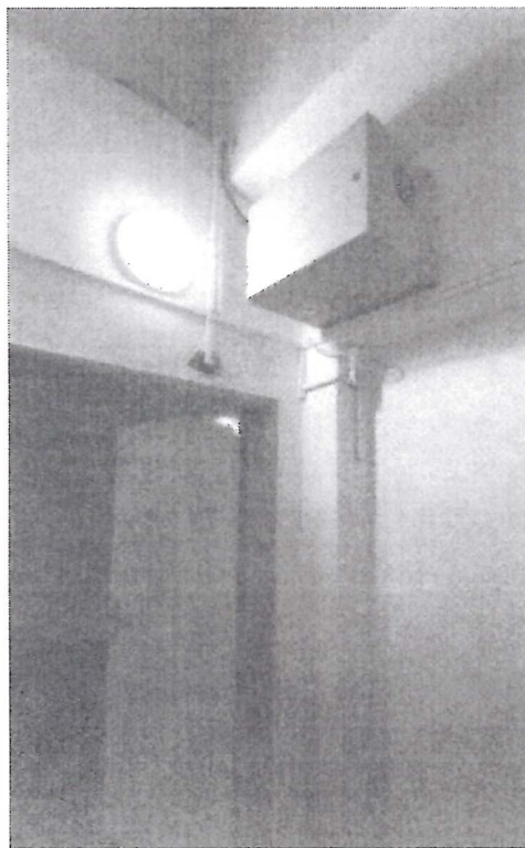
Obr.1 Rack 19" pro umístění technologie ve výtahové šachtě bloku č.11
