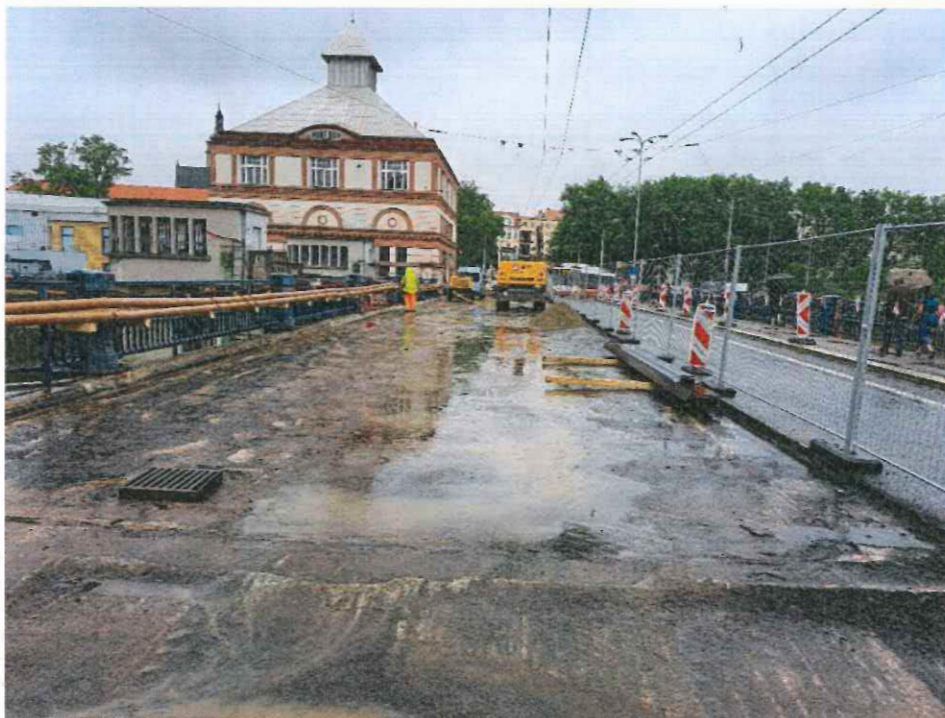
Obr. 1 - stav odvodnění po dešti na I. - II. pole, úžlabí je v ose jízdního pruhu
