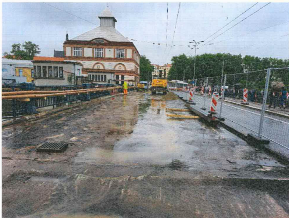
Obr. 1 - stav odvodnění po dešti na I. - II. pole, úžlabí je v ose jízdního pruhu
