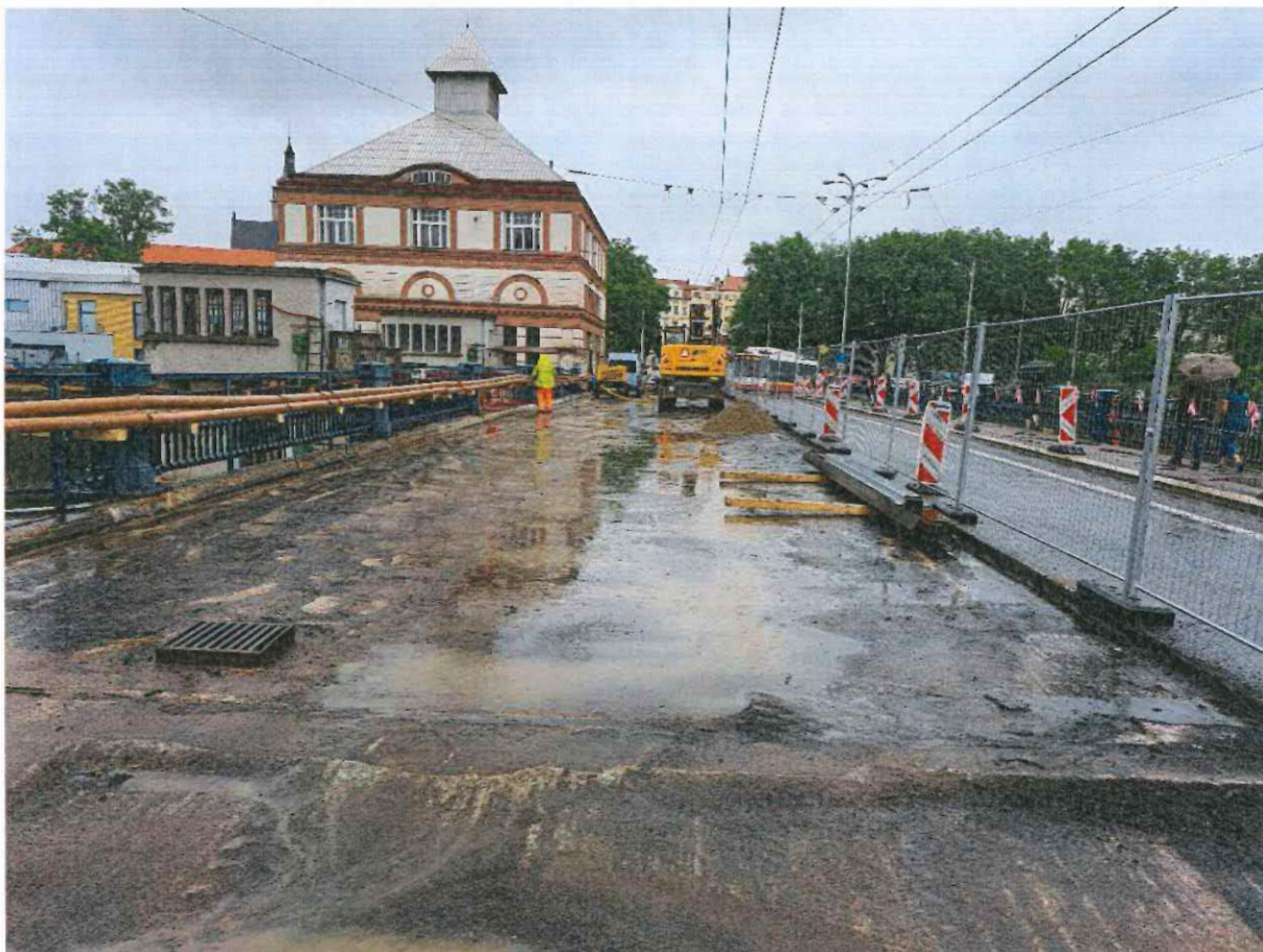
Obr. 1 – stav po odstranění hydroizolace, absence lůžka pro skladbu EMZ
