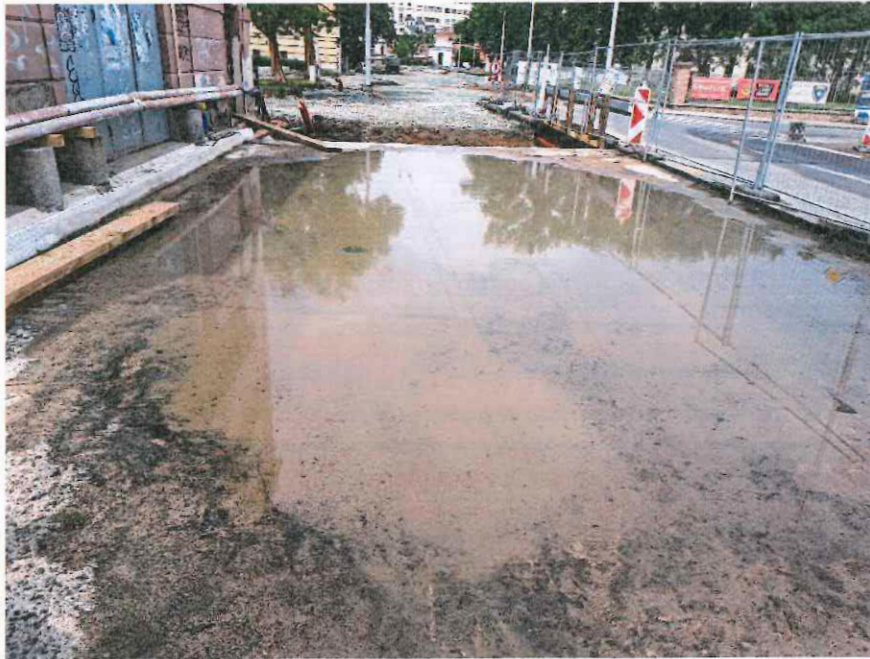
Obr. 2 - stav odvodnění po dešti III. pole, závěrná zídka je výše položená než pole => nemožnost odtoku vody
