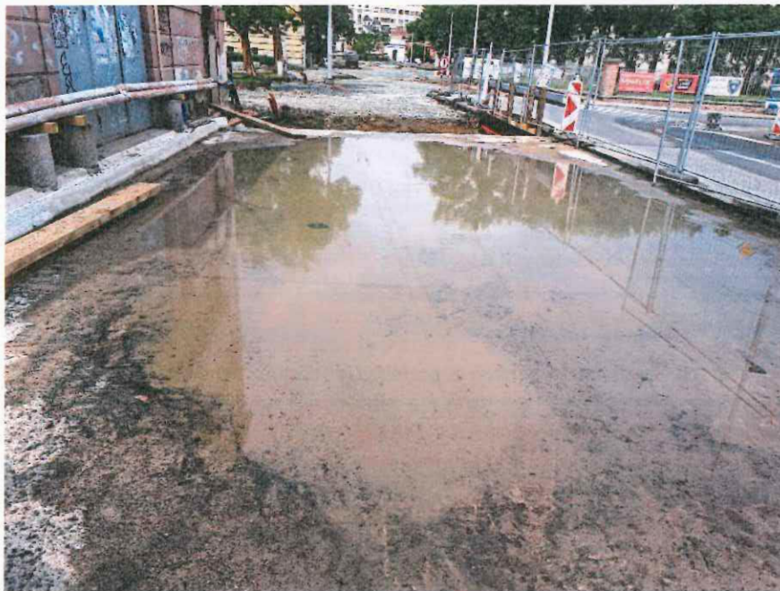
Obr. 2 - stav odvodnění po dešti III. pole, závěrná zídka je výše položená než pole => nemožnost odtoku vody
