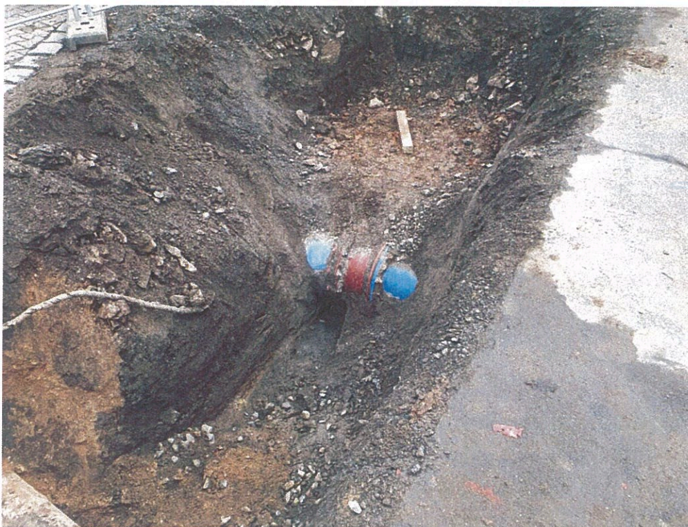
Kolize šachty s vodovodem – křižovatka Na Magistrále / Benešova
