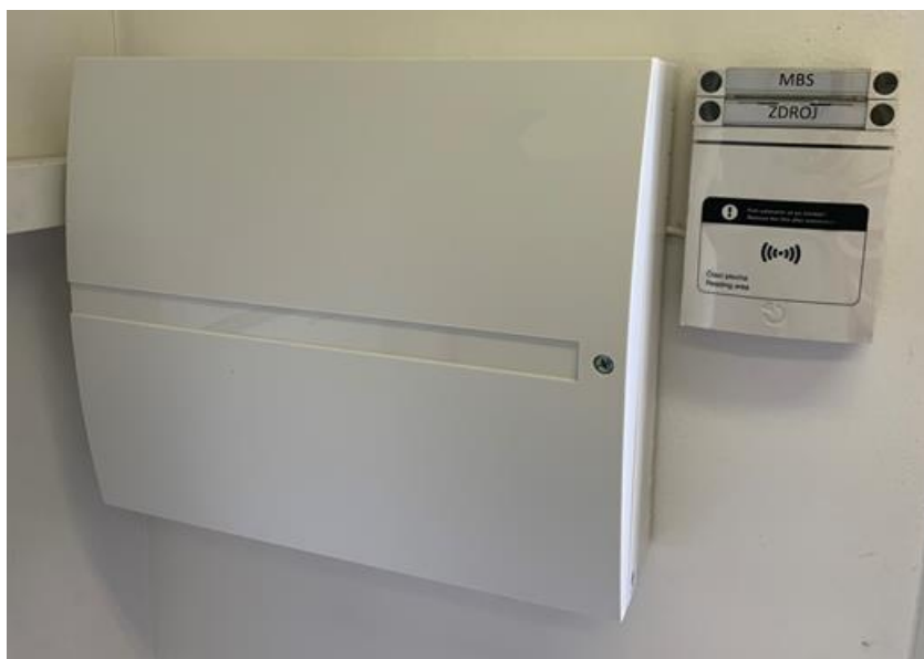
Obr. 6 – JABLOTRON ústředna JA-107K a přístupový modul JA-114E
