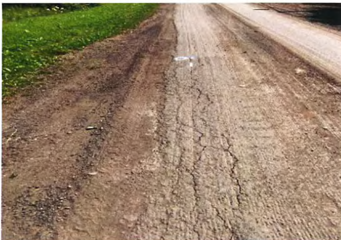
Charakteristické trhliny vyskytující se na všech úsecích
