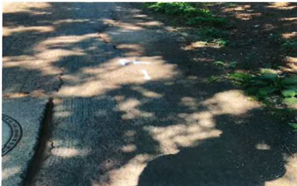
Úsek č.3- podélná trhлина na rozhraní rýhy kanalizace
