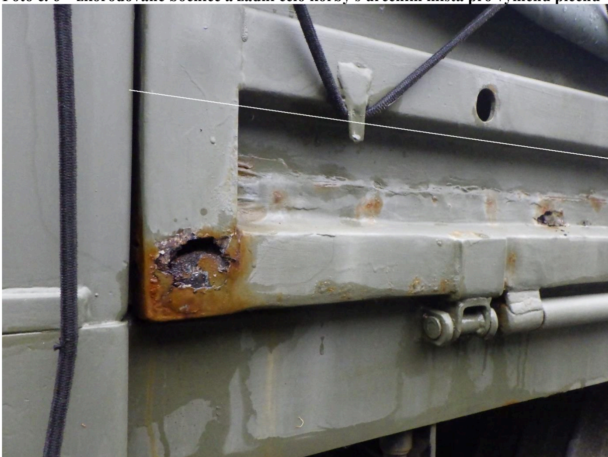
Foto č. 6 – zkorodované bočnice a zadní čelo korby s určením místa pro výměnu plechů
