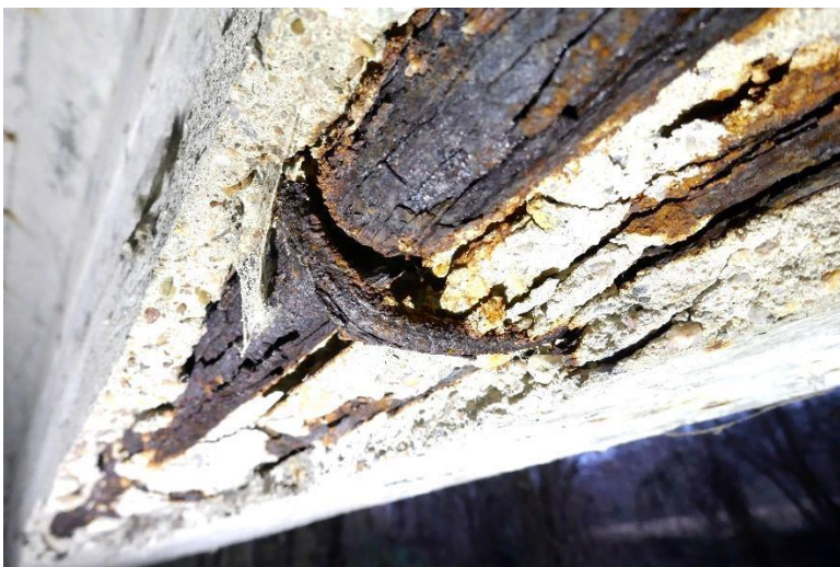
Uspořádání NK - zátékání a koroze – pohled do mostu zleva
