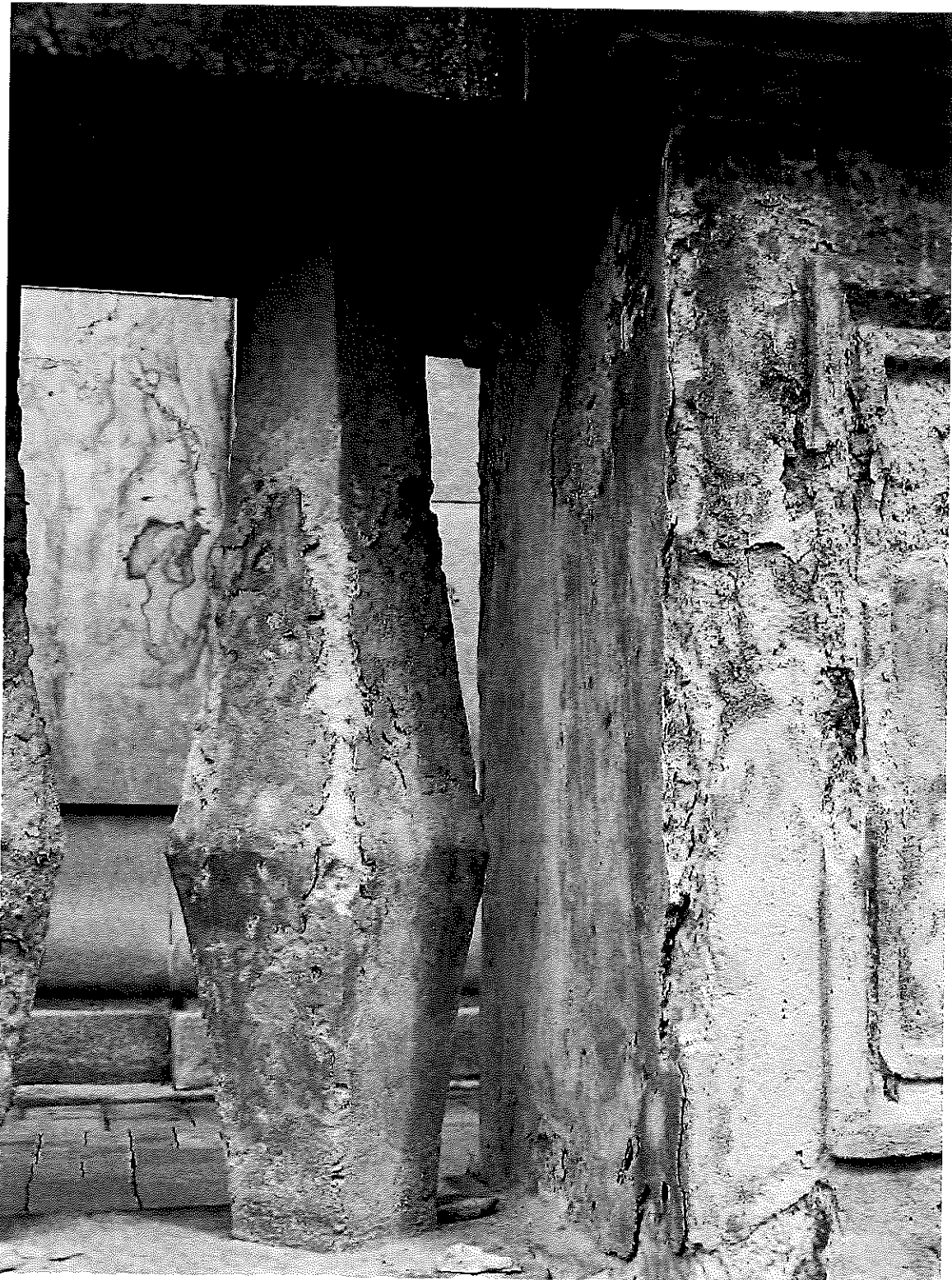
Snímek z roku 2012, na kterém je vidět silnou míru degradace kamene, která je v podstatě celoplošná
