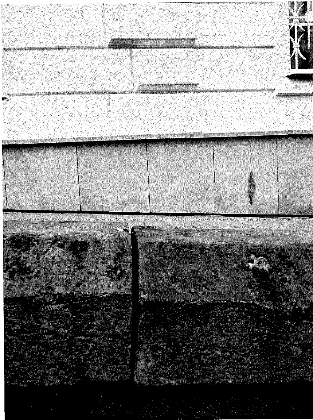
F40 – detail obruby přístupové rampy vpravo: detail chybějícího spárování a mírné posunutí dílů
