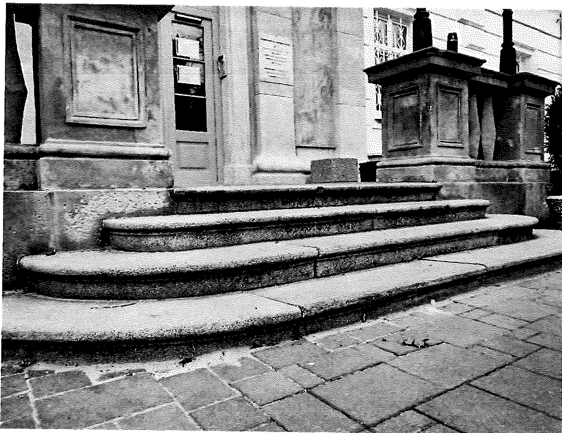
F59 – žulové schodiště: chybějící spárování
