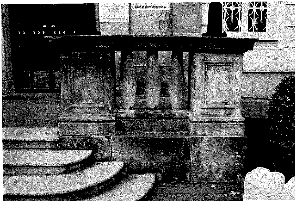
Snímek z roku 2012, na kterém je vidět silnou míru degradace kamene, která je v podstatě celoplošná
