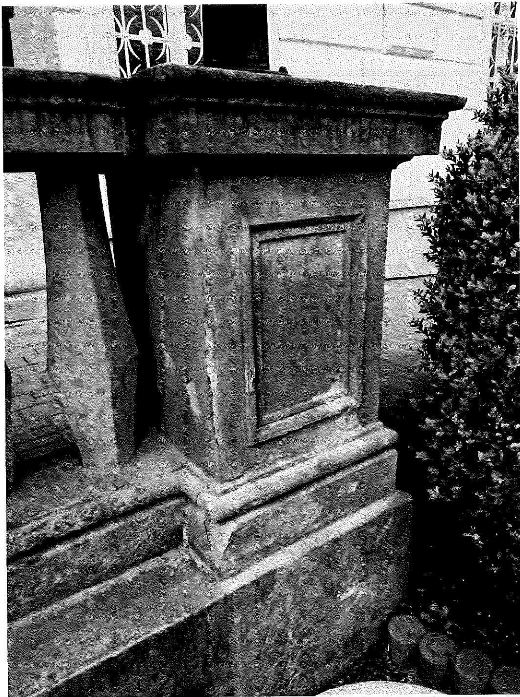
F5 – koroze kamene na sloupku V vpravo
