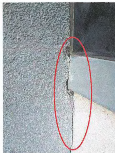
foto /38/ Detail styku stěny krčku a východní fasády předmětného objektu (u střechy krčku) - trhlina
