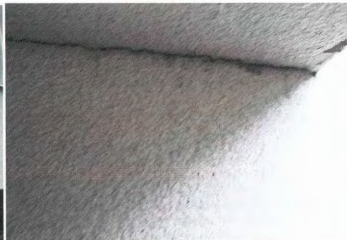
foto /42/ Trhlina na styku předsazené části fasády 1.NP vůči uskočenému 1.PP
