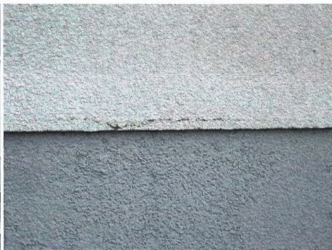
foto /20/ Detail trhliny na rozhraní základní lišty ETICS nad soklem západní fasády
