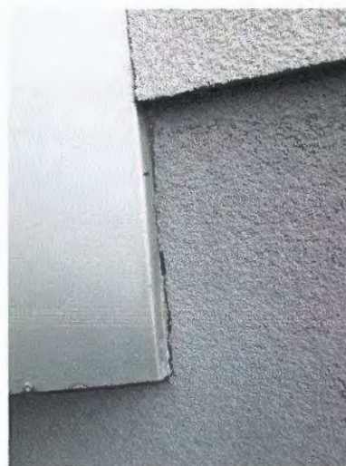
foto /24/ Detail z foto /23/ - trhlina v omítce u napojení na LOP
