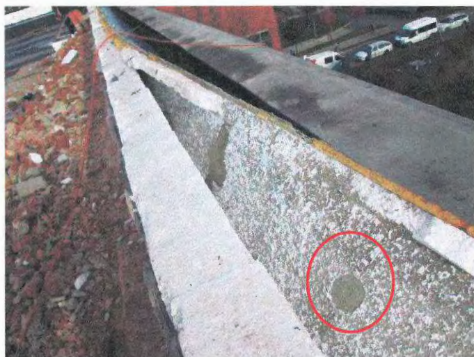
foto /33/ Vnitřní líc základní vrstvy (po ubourání zdiva atiky) s nadměrným množstvím stěrkové hmoty v místě kotvy
