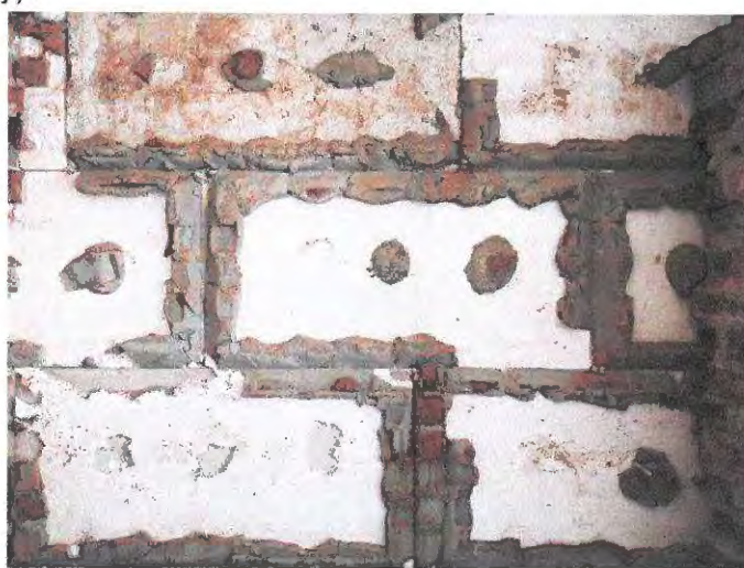
foto 1/2 Vnitřní líc ETICS po vybourání štitové stěny
