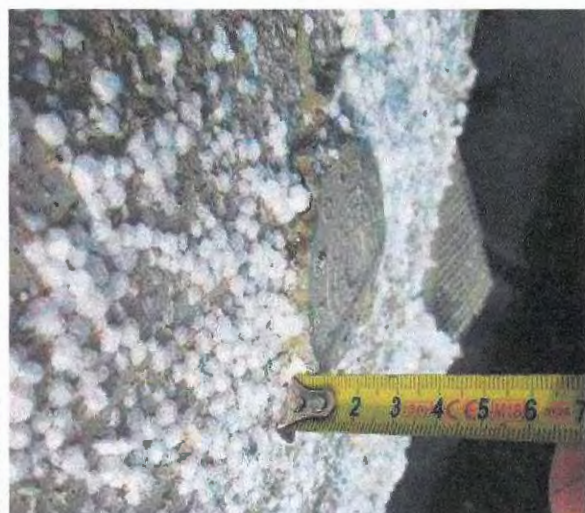
foto /34/ Detail stěrkové hmoty vyznačené na foto /33/ - signalizuje zapuštění kotvy, v daném případě o cca 8-9 mm
