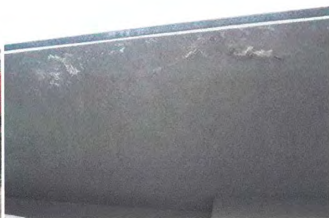
foto /18/ Výkvěty na pohledu střechy z foto /17/
