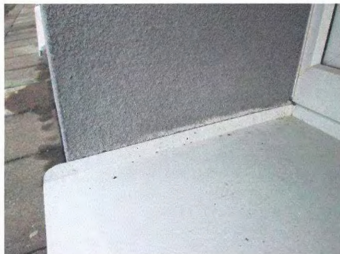
foto /21/ Parapet suterénního okna západní fasády – bílé výkvěty u ostění okna
