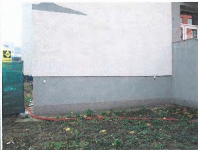
foto /28/ Povrch severního štítu je pokryt mikroorganismy
