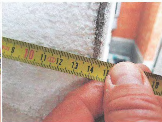
foto /12/ Detail základní vrstvy z foto /11/ - tloušťky 1,5 mm
